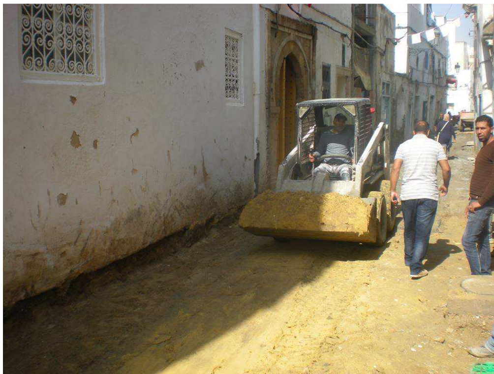
Figure IX-4 : Environnement immédiat de la bibliothèque « Dar Ben Achour » (photo prise durant la période de notre enquête – chantier de réhabilitation en cours)
