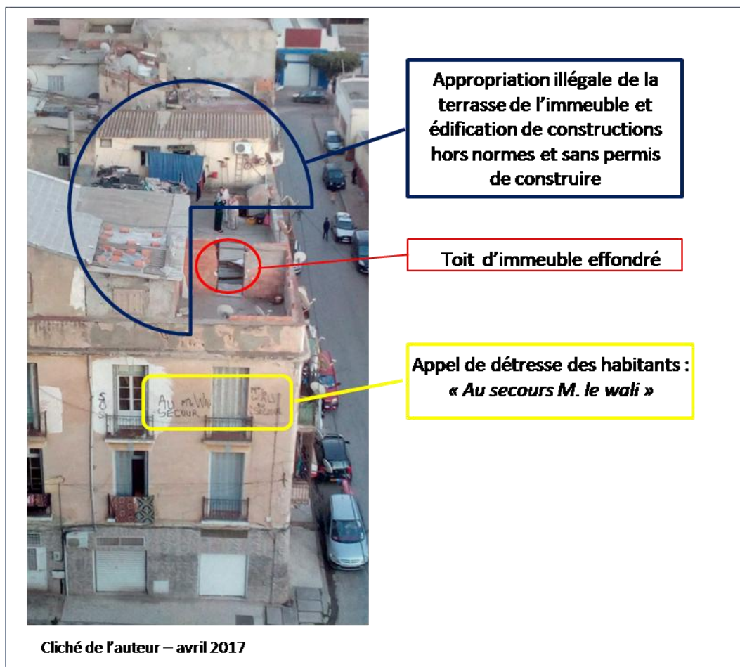
Figure 8 Exemple d'immeuble ancien menaçant ruine dans le quartier de Gambetta à Oran
