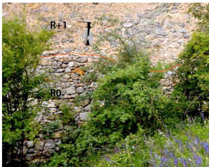
Figure 172 : Niveau R0 d'un édifice antérieur réemployé dans le bâtiment BLA 1100 (Blainon, Saint Etienne-de-Tinée). Cl. et DAO de V. Labbas.
