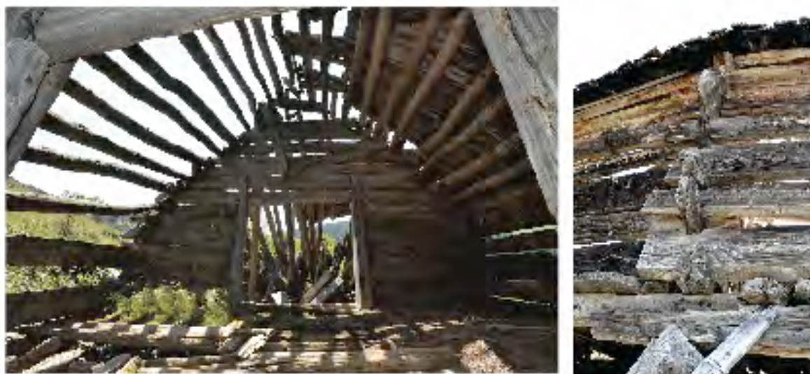
Figure 155 : Bâtiment LIB 100 (Liberture, Beuil). Le refend-formant-pignon vu de l'ouest (à gauche) et détail des emboitements vu du gouttereau sud (à droite). Cl. V. Labbas.
