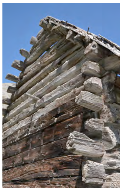
Figure 137 : Mailles empilées du pignon sud du bâtiment RUS 300. Les mailles supérieures sont circulaires et plus fines que les mailles inférieures. Cl. de V. Labbas
