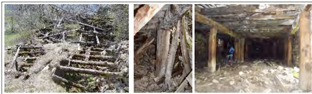
Figure 74 : trois exemple de plancher sur poteaux à Allos (à gauche la ferme de Banivol, au centre une ruine en amont du hameau de Bouchier et à droite la ferme basse de Vacheresse, vol.3 commune d'Allos).
