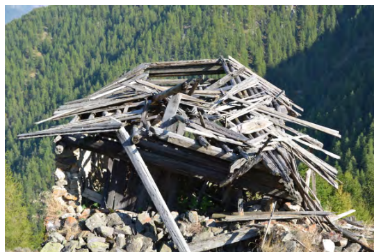
Figure 152 : Refend-formant-pignon en empilage sur une grange bâtie en maçonnerie (site de Pymia, commune d'Isola). Cl. de V. Labbas.
