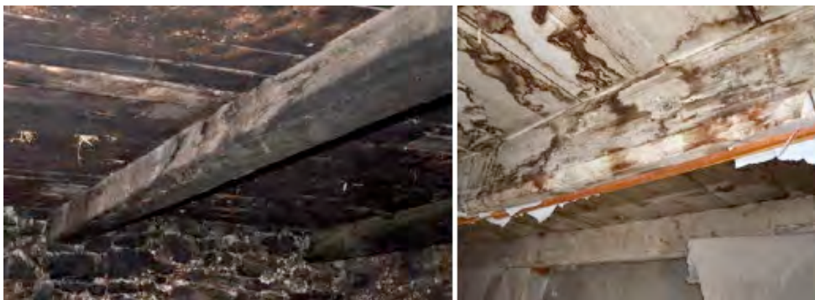
Figure 160 : Poutres équarries des plafonds des bâtiments BLA 1100 (à gauche) et CR 100 (à droite). Cl. de V. Labbas.
