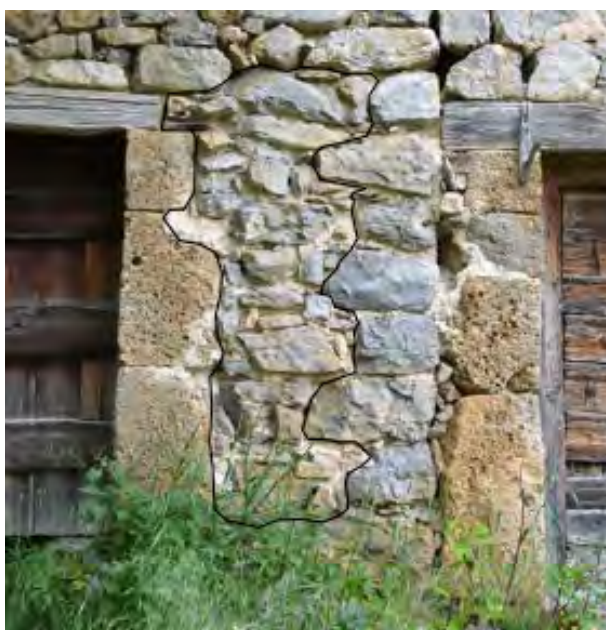
Figure 113 : Rejointoiement en R0 entre le chaînage sud et le piédroit de la porte. Cl. V. Labbas
