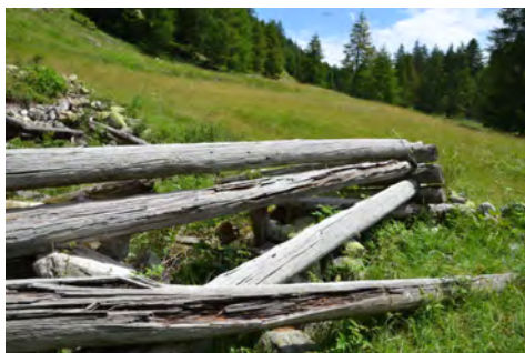
Figure 154 : Granges bâtie en empilage de mailles dans le quartier de Chiaïssie (Vallon de Mollières, Valdeblore). Cl. de V. Labbas.
