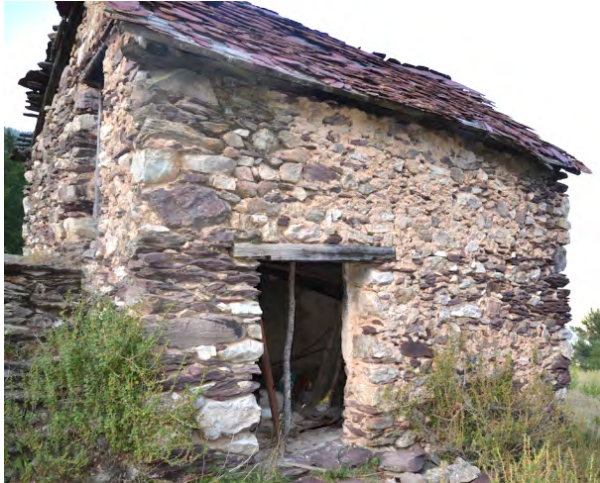
Figure 147: bâtiment construit dans le premier tiers du XIXe siècle en maçonnerie de mortier de chaux à Rougios. Cl. de V. Labbas.
