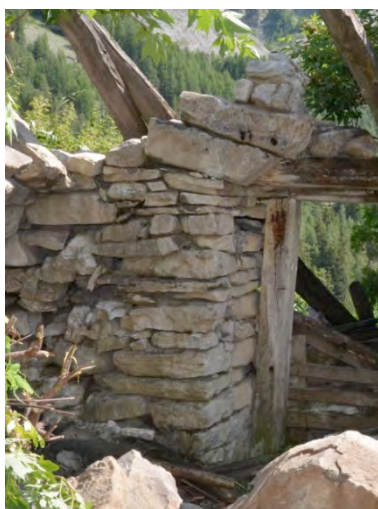
Figure 58 : vestiges d'arc au dessus de la porte de l'unité 3. V. Labbas
