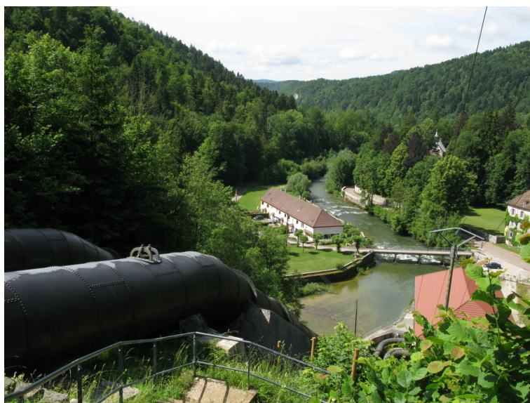
FIGURE 8.16 – Les conduites et la centrale EDF de Bourg-de-Sirod (Cliché : S. Flaminio, juin 2015). Cette centrale d'abord mise en service en 1922 est aujourd'hui concédée à EDF. Elle est exploitée au fil de l'eau malgré son importante hauteur de chute (48 mètres), une galerie souterraine d'aménée de 400 mètres de long et des conduites forcées atteignant 100 mètres de longueur. Elle dispose d'une puissance installée de 5 MW.
