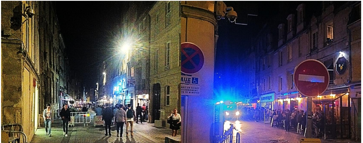
Figure 225 – Caméras de vidéosurveillance installées rue Écuyère (réalisation É. Walker, septembre 2018)
