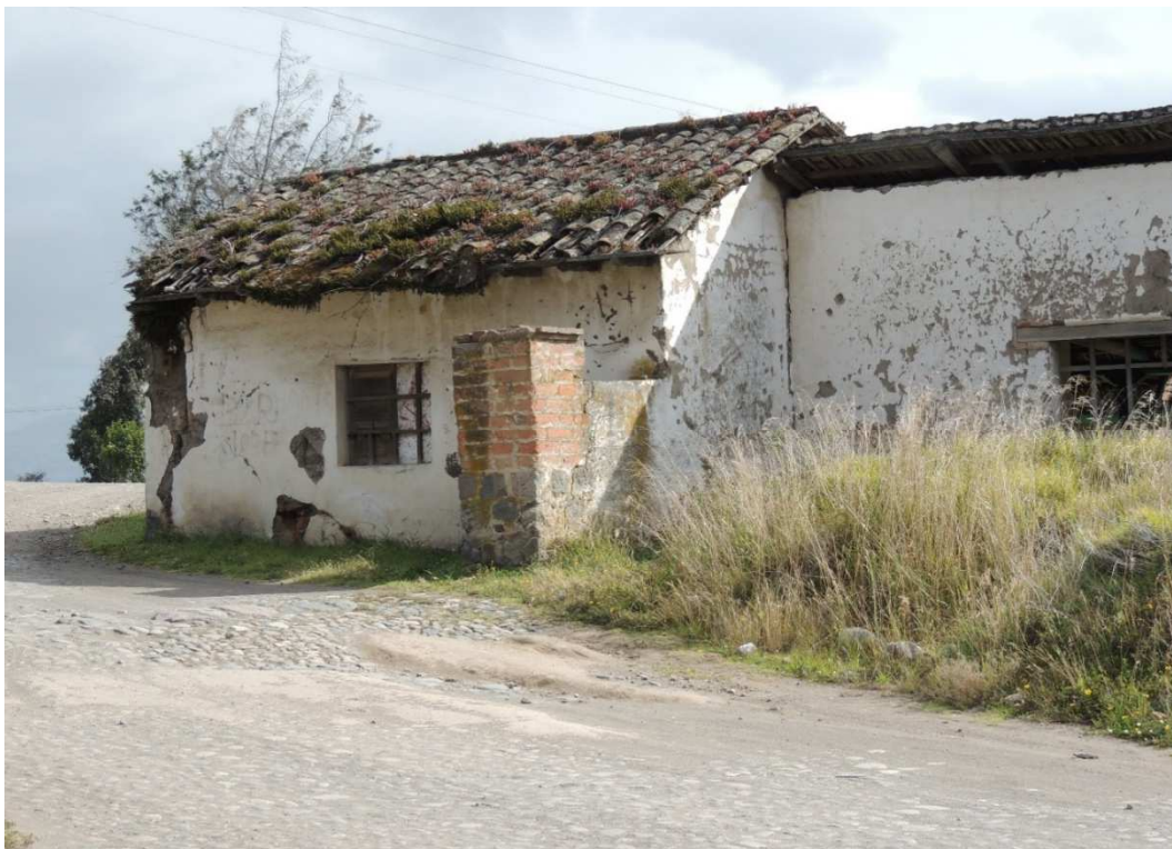
Photo No. 1 et 2 : Une partie de l'ancienne Maison de l'hacienda « La Chimba », actuellement abandonnée.
