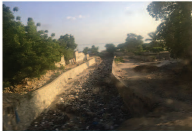
Figure 9 : Photographies de ravines à Port-au-Prince 33
