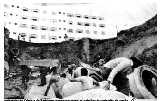
Funcionários da Cohab e da Prefeitura começaram ontem os trabalhos de contenção de erosão. ↑ Erosão ainda é ameaça Folha de S. Paulo - 6/11/80 p. 13 Cohab iniciou obras de contenção, em Itaquera
