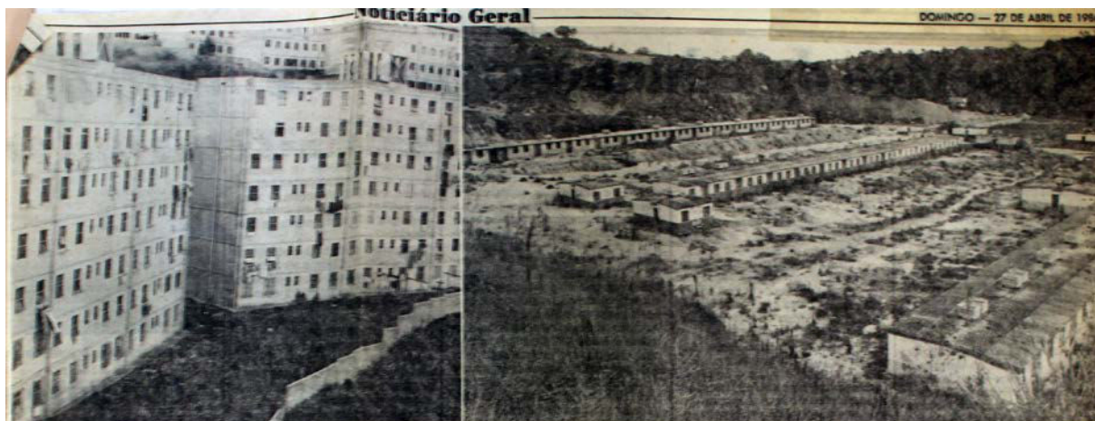
Carapicuíba: as placas das paredes estão caindo
