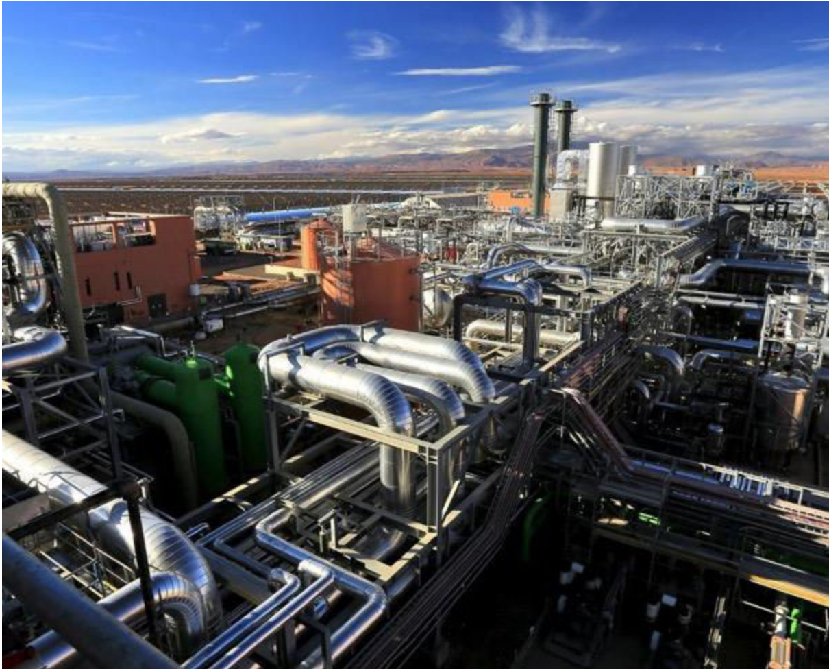
Figure 42 Photographie vue sur la centrale solaire Noo1.
