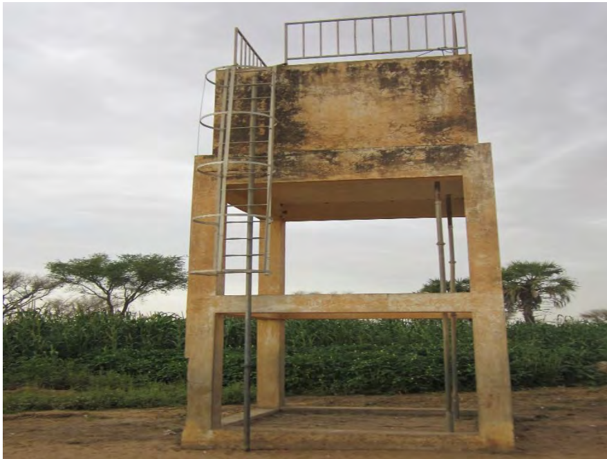
Photo 2 : la mini adduction d'eau potable du village de Tillim construit en 1997
