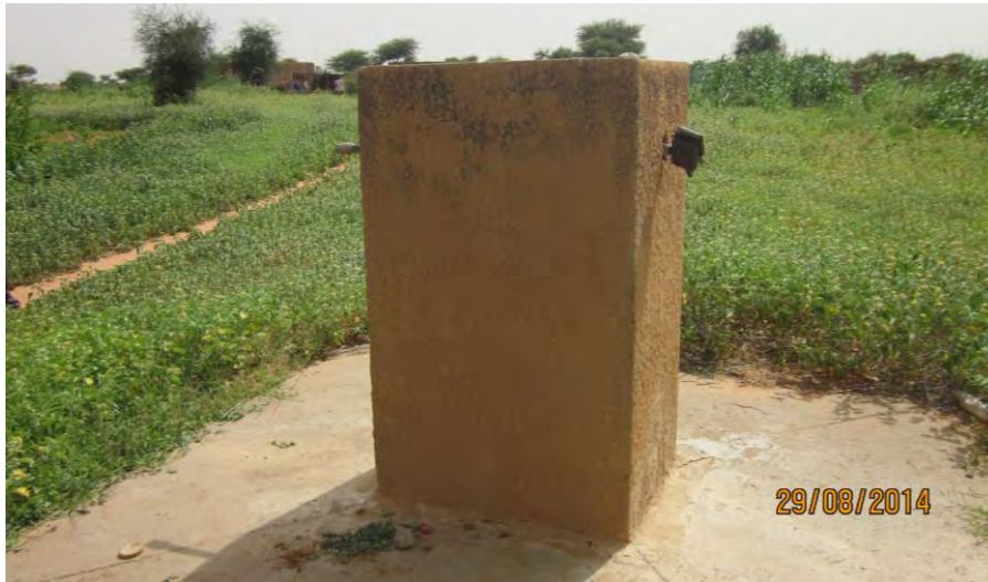
Photo 28 : une borne fontaine abandonnée car ne recevant plus d'eau depuis 15 ans (quartier Douane)
