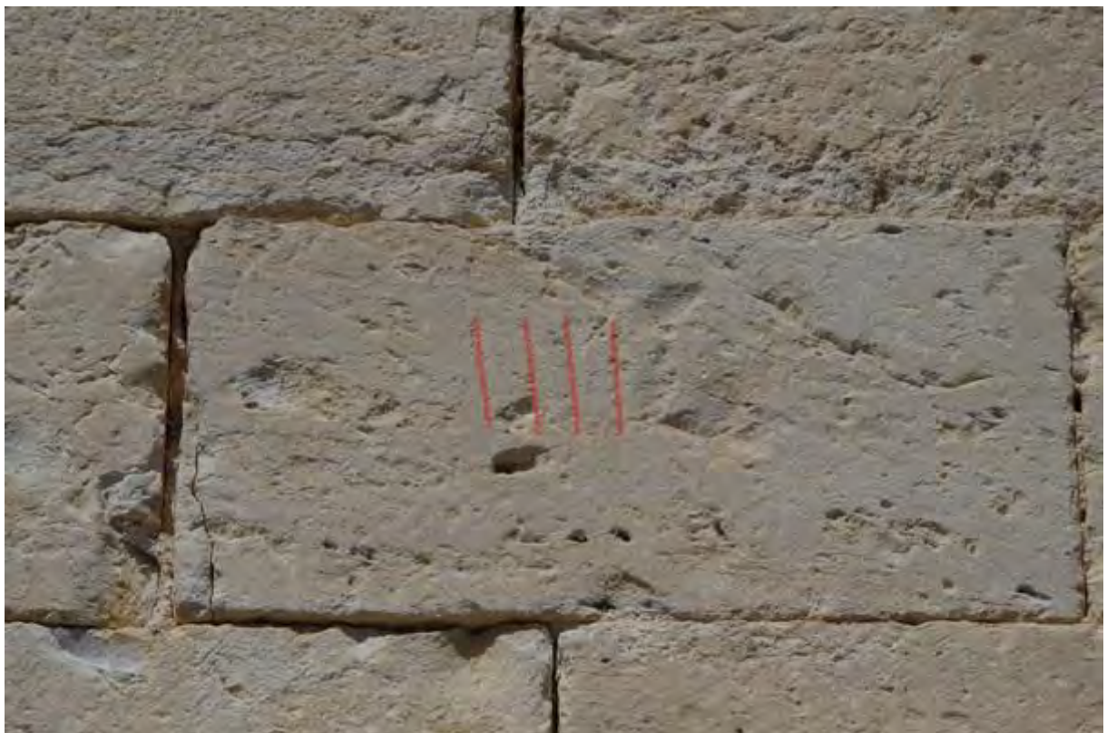
Fig. 101 : potentielle marque de carrier (repassée en rouge par nos soins) sur le parement du mur nord de la nef de la collégiale Saint-Martin.
