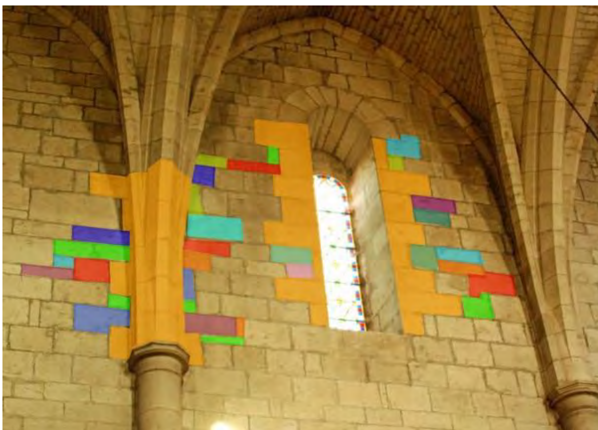
Fig. 95 : schématisation de l'élévation des éléments structurants et des murs de la nef de la collégiale Saint-Martin. En orange : les éléments structurants montés en premiers ; en couleurs : les lits de pierres montés au fur et à mesure.
