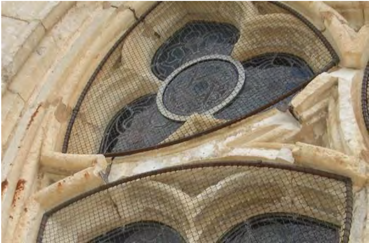
Fig. 122 : détail du scellement au plomb du réseau de la rosace de la collégiale Saint-Martin.
