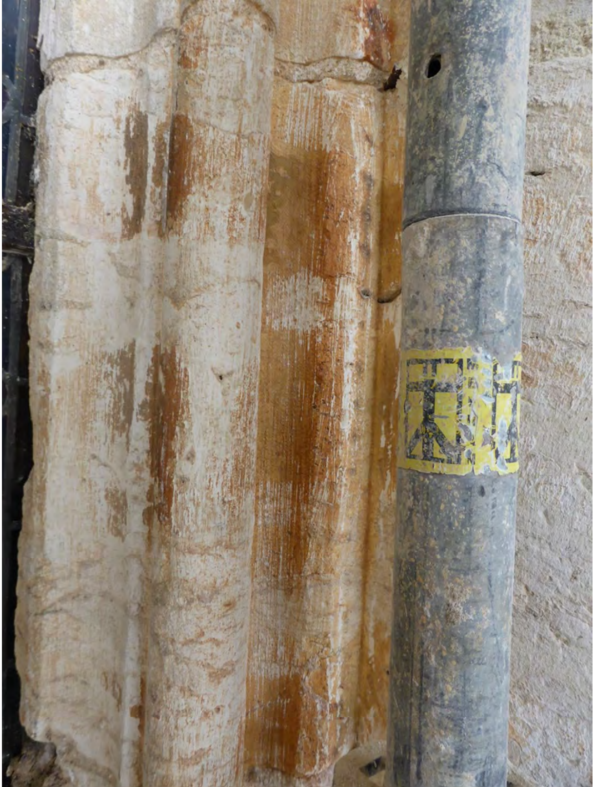
Fig. 158 : traces de lœau-forte vermillon sur les jambages de la baie dœaxe de la collégiale Saint-Martin.
