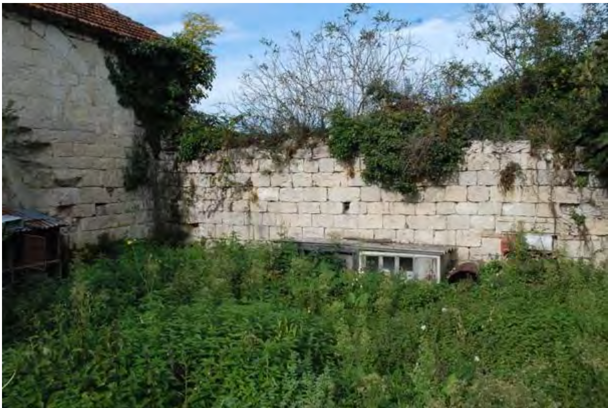
Fig. 110 : vue générale du mur nord de l'église du couvent du Pouget. État en septembre 2015.
