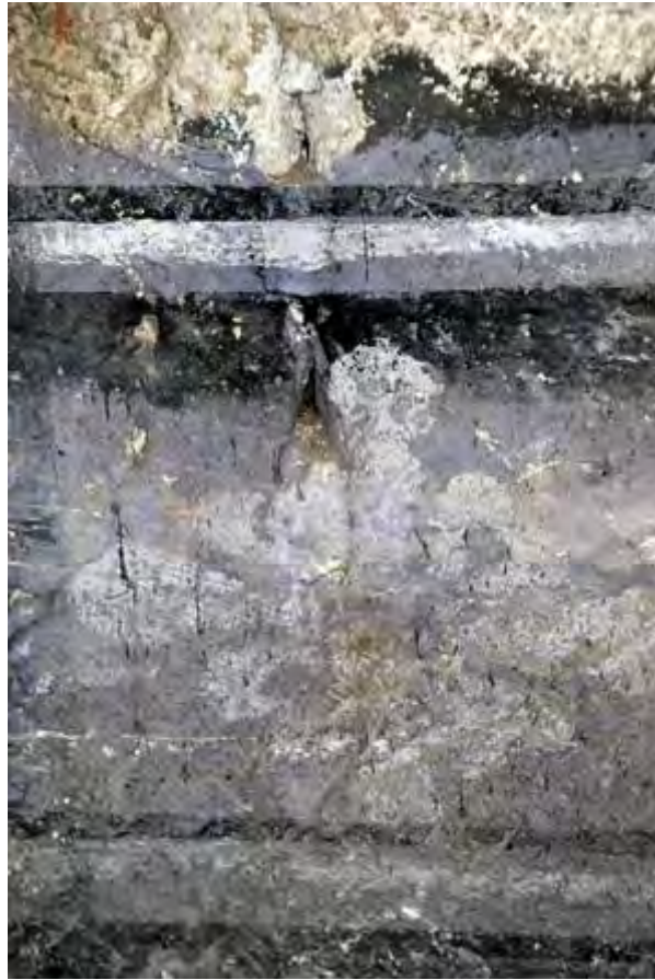
Fig. 138 : détail du décor peint mis au jour dans la quatrième chapelle nord de la collégiale Saint-Martin.
