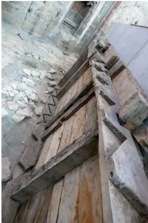
Fig. 257 : crémaillères de l'escalier d'accès à la tribune, remployé en renfort des estrades des stalles. Collégiale Saint-Martin.
