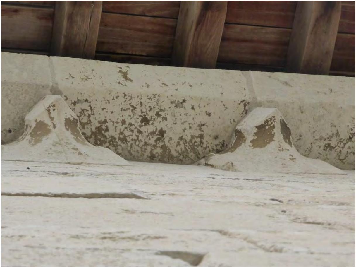
Fig. 160 : traces d'une eau-forte terre d'Ombre sur les modillons nord, collégiale Saint-Martin
