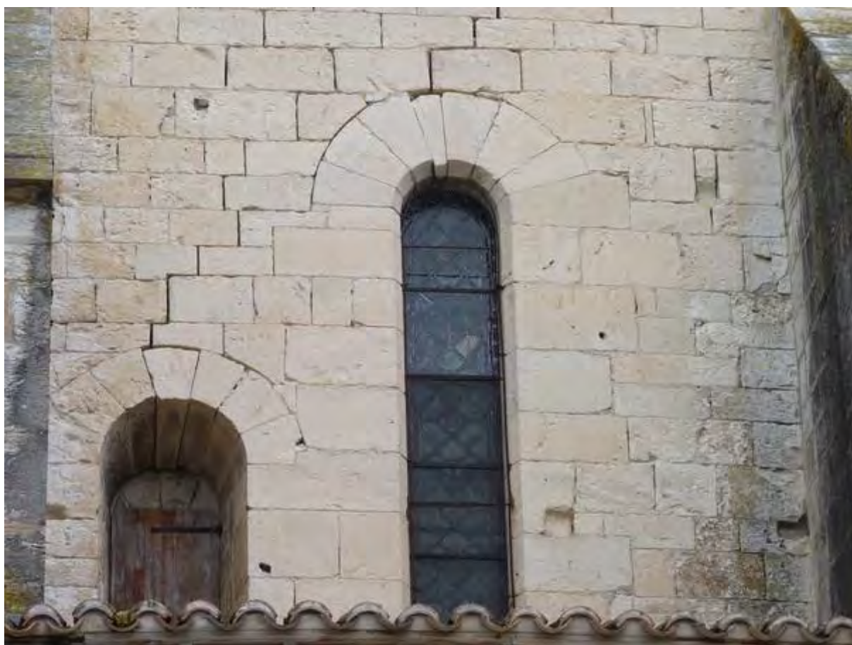
Fig. 103 : vue de la porte d'accès aux toitures du bas-côté sud de la collégiale Saint-Martin.
