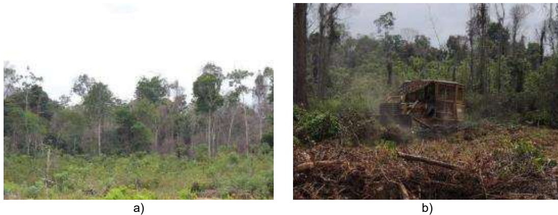
Figure 82. a) Succession forestière initiale au premier plan et forêt primaire dégradée à l'arrière-plan, dans l'assentamento Camapuã. b) Suppression de la forêt dégradée avec un bulldozer sur chenilles, près de l'invasion Oriente. Photos : R. Osis (2017).
