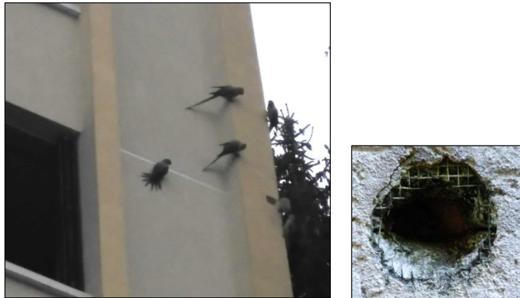
Photographies 4-20 et 4-21 : A Palaiseau (91), des perruches ont creusé dans l'isolation extérieure d'un immeuble pour faire leur nid.
