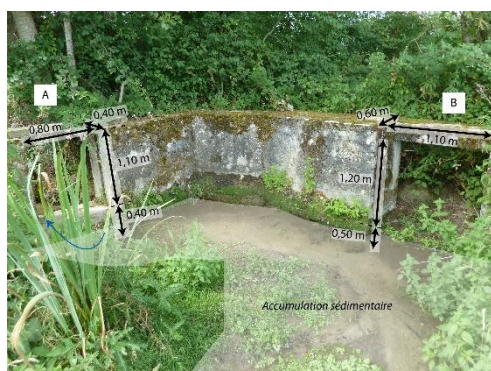
Figure 98. Partiteur de débit sur l'Aubance à Louerre (Source : GP – 05/07/2017)
