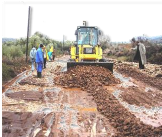
Sédiments déposés sur la route de Affela N'ifrane lors de la crue du janvier 2008.
