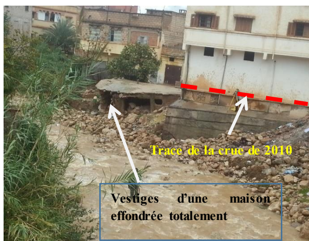
Dégâts et destruction des maisons par les crues de l'Oued Ikkour dans le quartier d'Ikkour (Zaouit Echiekh)
