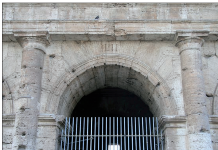
Figure A.38. Utilisation du Lapis tiburtinus dans les voûtes du Colisée à Rome (I er s. ap. J.-C.) ; notons l'effet visuel obtenu par le jeu avec la lamination naturelle du travertin.
