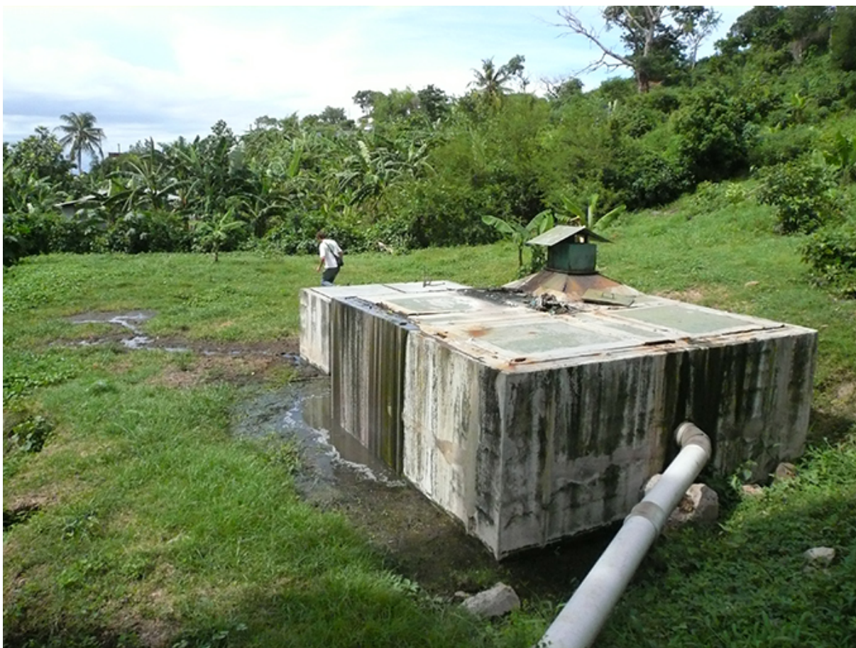
Image 6 : Station d'épuration dysfonctionnelle à Mayotte (Crédit photo. S. Becerra, 2008)
