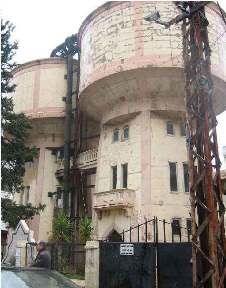
Photographie 1 - Château d'eau de Mouayssara, construit en 1930 pour l'alimentation de Tripoli à partir de la source de Rachaine, quartier de Abou Samra (C. Allès, 2011)
