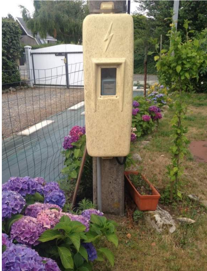
Fig. 48 — Un compteur d'électricité inaccessible (Source : photographie personnelle, environs de la Baule, Loire-Atlantique, 28 avril 2016)
