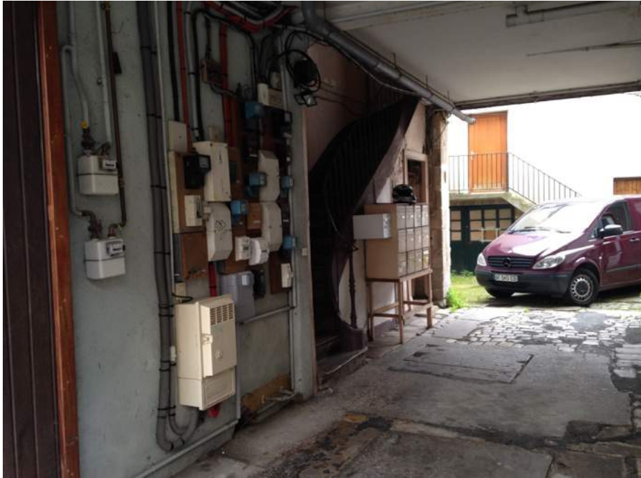
Fig. 55 — Ribambelle de compteurs au rez-de-chaussée d'un immeuble (Source : photographie personnelle, Chinon, Indre-et-Loire, 2014)
