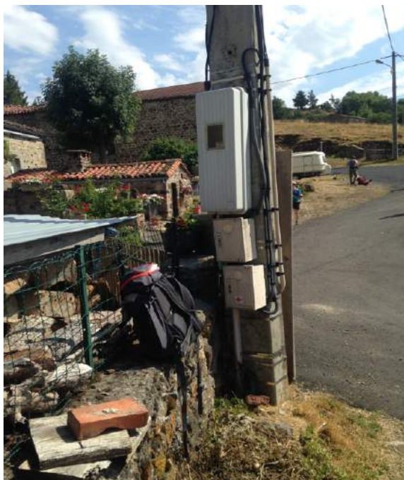
Fig. 54 — Le compteur sous la logette (en haut) directement raccordé au poteau électrique (Source : photographie personnelle, Montbonnet, Haute-Loire, 2015)
