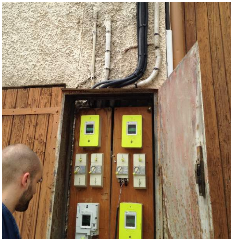
Photographie 1 — Quatre compteurs Linky raccordés dans la cour d'une copropriété sans contact avec les clients. Zone périurbaine. 1
