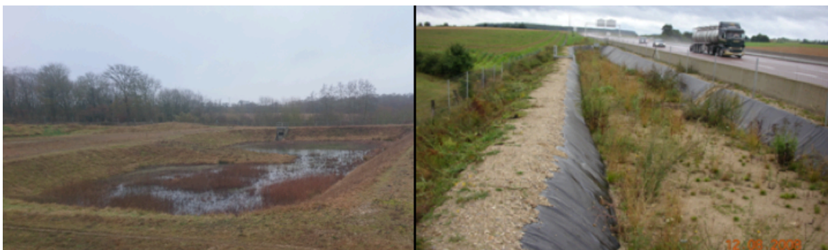
Figure 6 : Bassin d'infiltration (gauche) et de filtration (droite)
