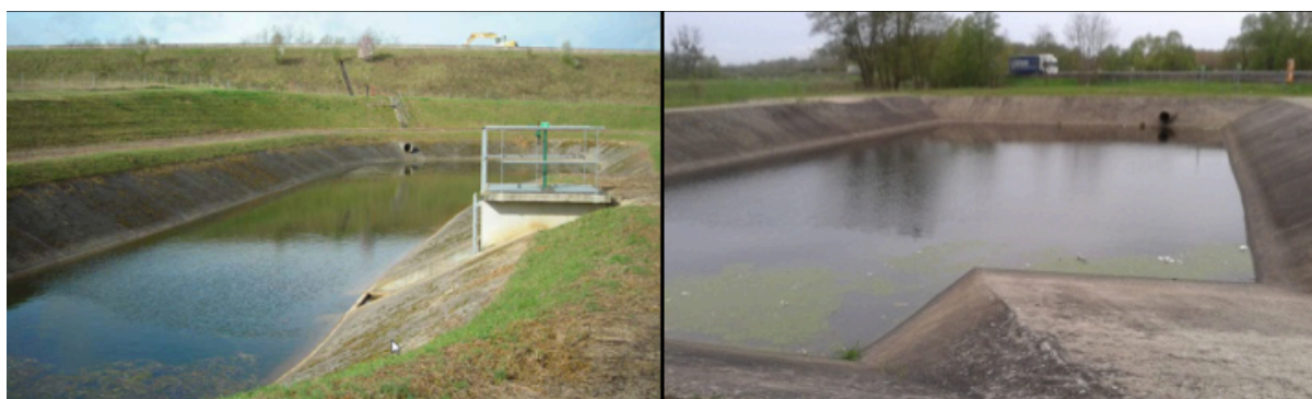
Figure 7: Bassin de traitement (gauche) et de confinement (droite)
