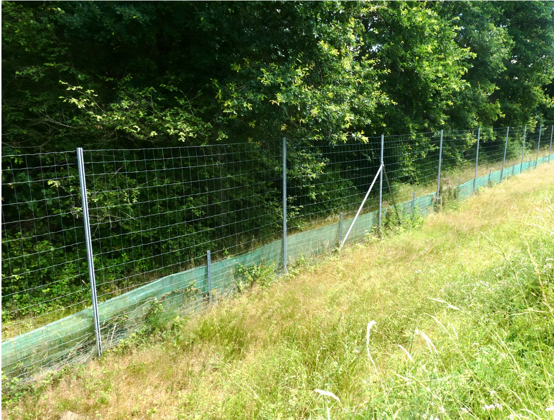
Figure 30 : Filet anti-batraciens installé autour d'un bassin de l'autoroute A77
