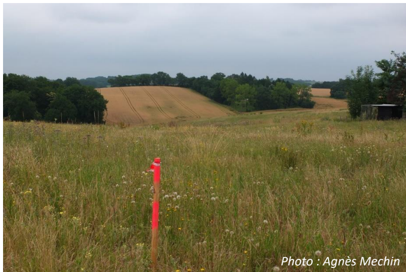
Figure 23 : Projet de gazoduc, avant le démarrage des travaux. Le piquetage délimitant la zone d'emprise du chantier a été réalisé.
