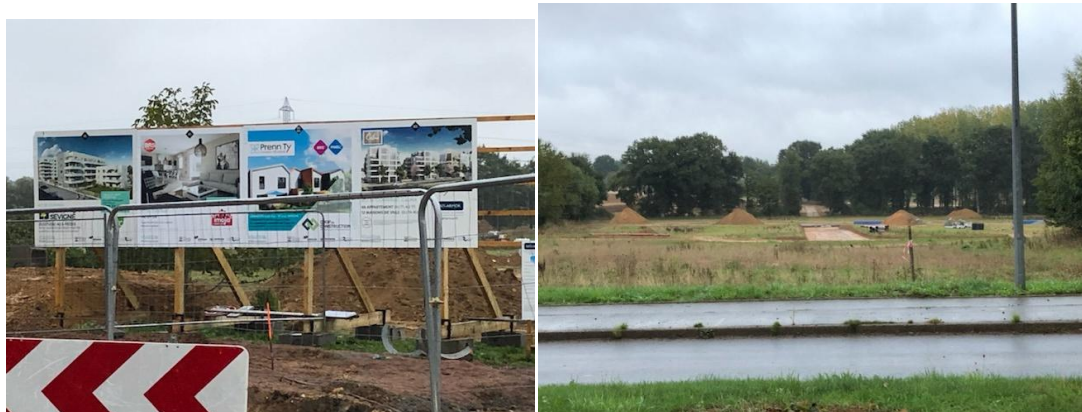
Figure 99 : Vues de la ZAC des Pierrins avec travaux de terrassement en Octobre. 2019, (Photographies de l'auteur).
