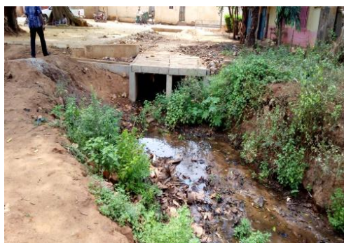
Photo 62 : Etat des collecteurs à Ouidah
