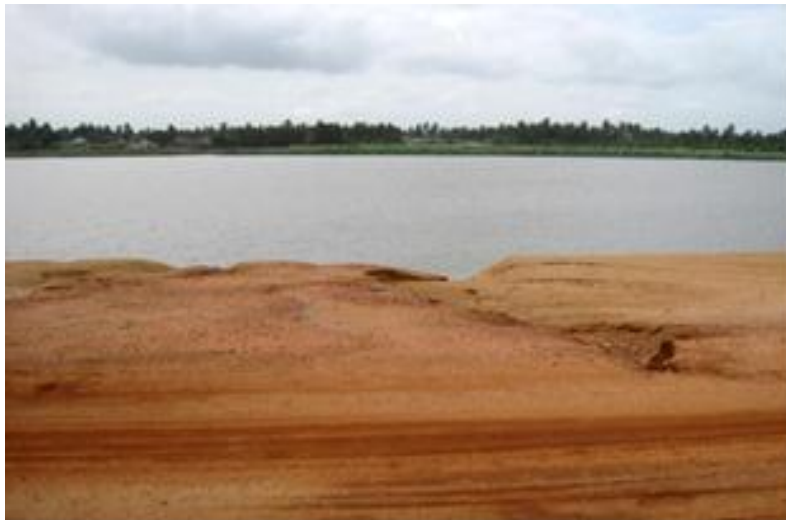
Photo 79 : Dégradation de la route des pêches entre Apoutagbo et Agonèkanmè à Grand-Popo
