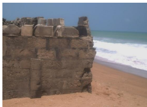
Photo 78: Habitation rattrapée par l'érosion Côtière à Grand-Popo
