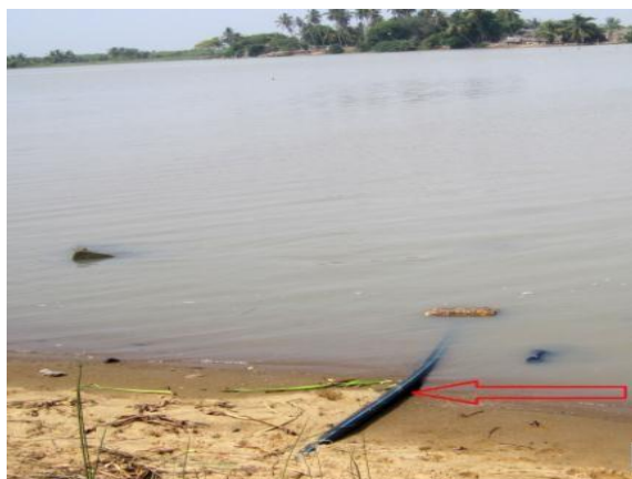
Photo 85 : Conduites de canalisations d'eau de la SONEB mise à nue
