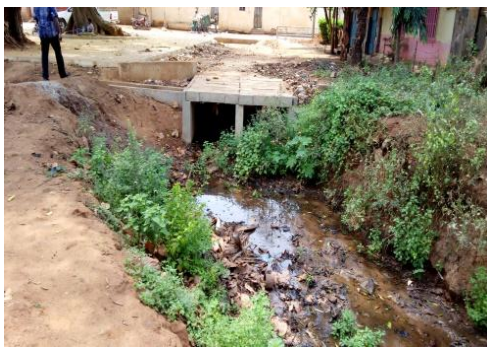
Photo 62 : Etat des collecteurs à Ouidah
