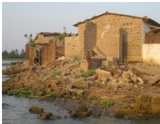
Photo 82 : Aperçu d'habitations effondrées
