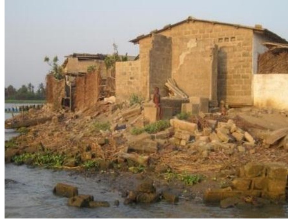
Photo 82 : Aperçu d'habitations effondrées
