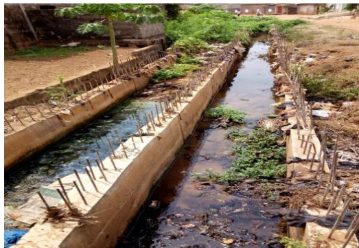
Photo 63 : Collecteurs abandonnés à Ouidah
