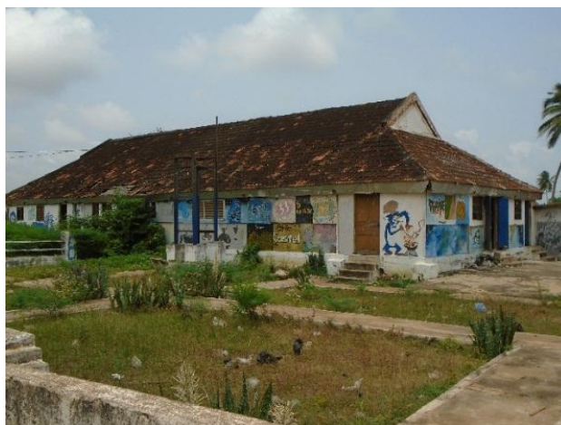
Photo 53 : Etat actuel de la gare ferroviaire de la ville de Ouidah Prise de vue : Dansou, décembre 2018
