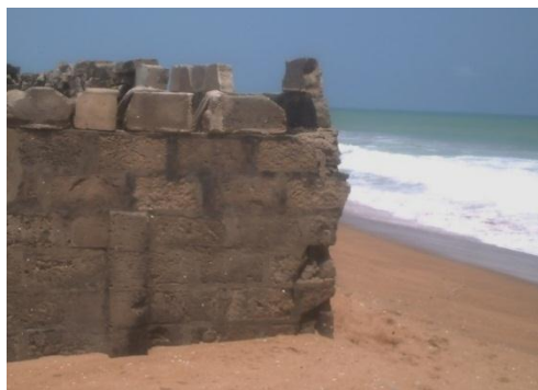
Photo 78: Habitation rattrapée par l'érosion Côtière à Grand-Popo
