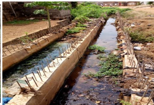
Photo 63 : Collecteurs abandonnés à Ouidah
