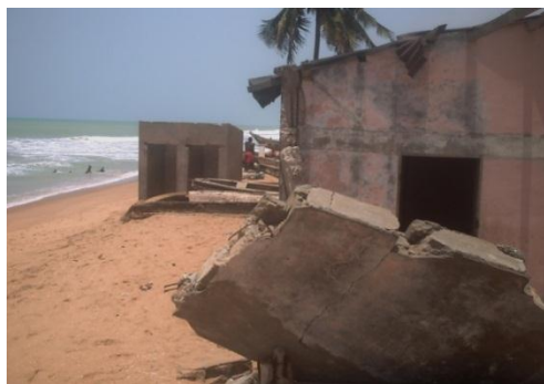
Photo 77 : Maisons et latrines détruites par l'érosion Côtière à Grand-Popo
