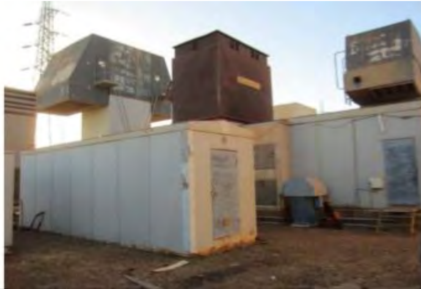
Photo 29 : 2 turbines à combustible de Niamey II Source : NIGELEC, 2017
