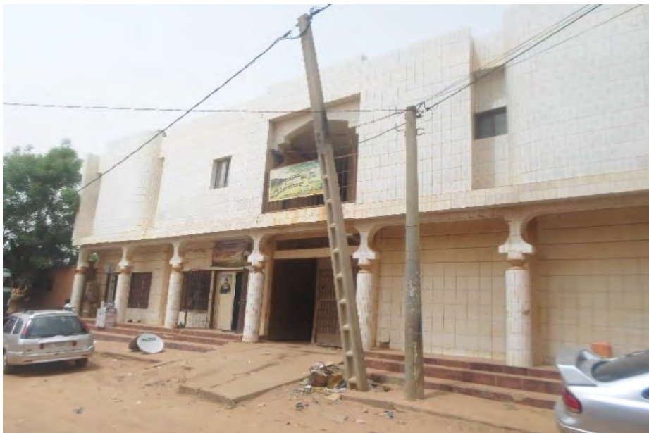
Photo 13: Poteau électrique en béton en état de dégradation dans le quartier Liberté Source : Abdourazack N. A., 2018
