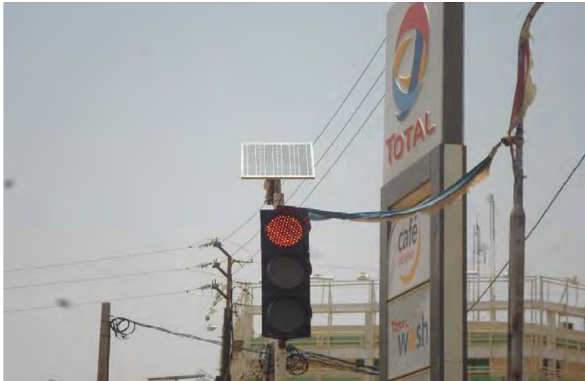
Photo 44 : Feu de signalisation fonctionnant à l'énergie solaire Source : Abdourazack N. A., 2018
