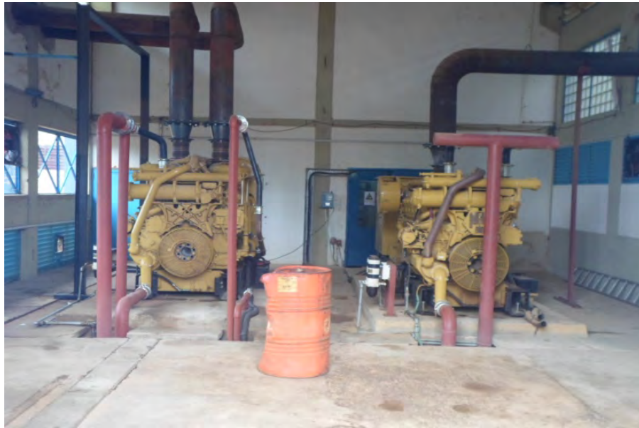
Photo 53 : Groupe électrogène de la station de pompage de Goudel
