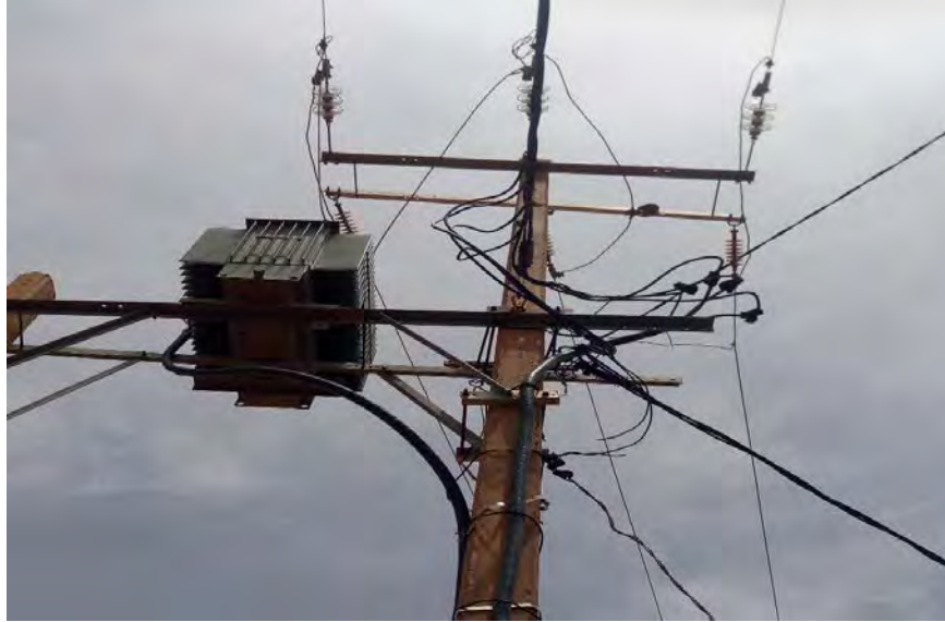
Photo 32: Portique nouvellement installé dans un quartier périphérique de Niamey Source : Abdourazack N. A., 2018
