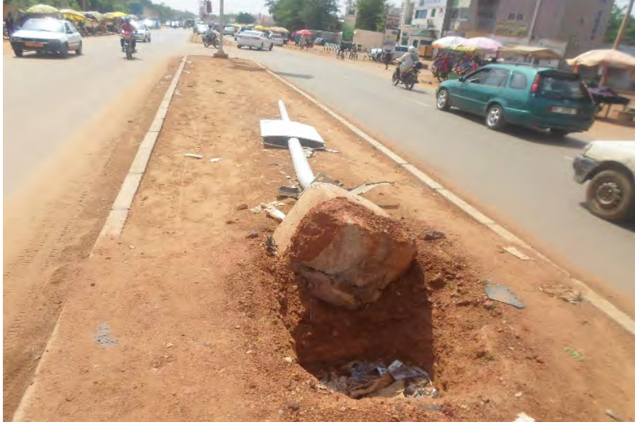
Photo 9 : Lampadaire arraché par un accident de circulation Source : Abdourazack N. A., 2018
