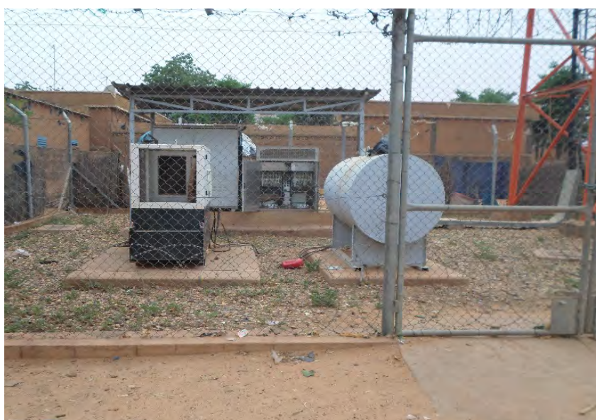
Photo 55 : Antenne de téléphonie mobile équipée d'un générateur de secours dans le quartier Lazaret
