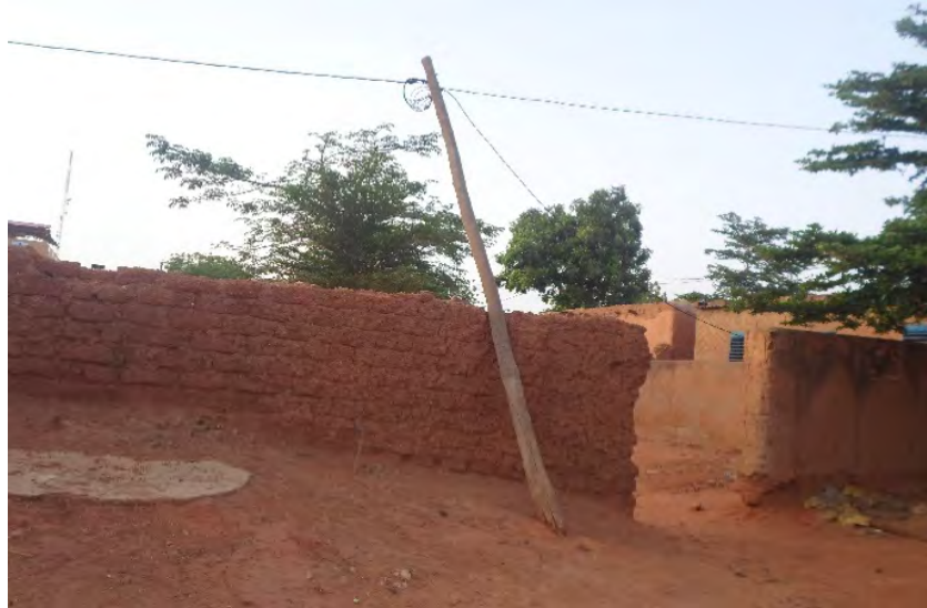
Photo 14 : Poteau électrique en bois en état dégradé dans le quartier Lazaret Source : Abdourazack N. A., 2018
