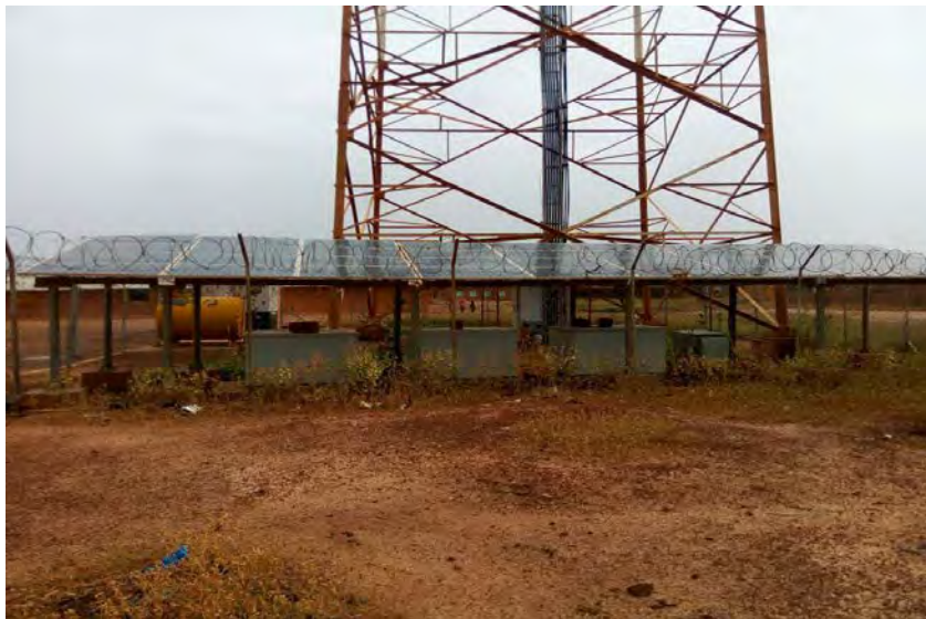
Photo 59 : Usage du photovoltaïque pour l'alimentation d'une antenne téléphonique à Mangaïzé (Ouallam) Source : Abdourazack N. A., 2018
