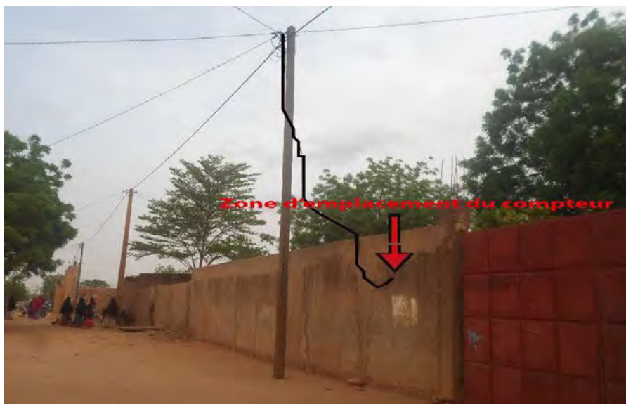
Photo 52 : Compteur placé sur un mur Source : Abdourazack N. A., 2018
