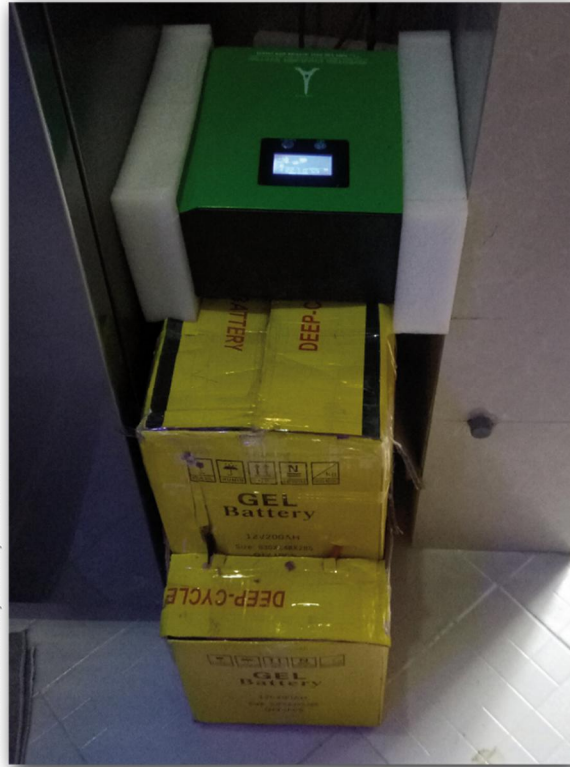
PHOTO 74 : BATTERIES ET LEUR CHARGEUR DE MARQUE « BOB PALIS »
