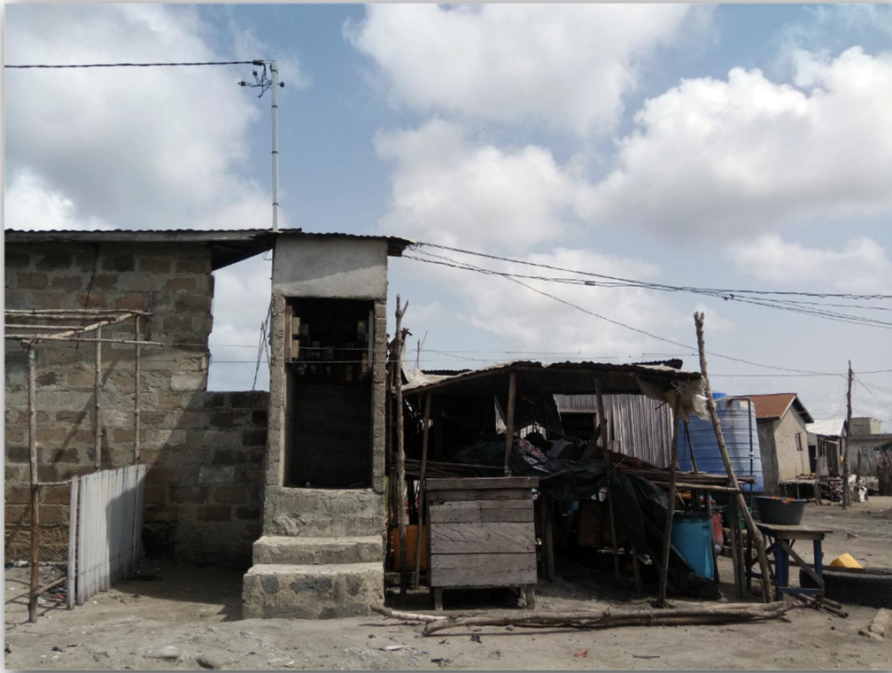
PHOTO 51 : CABANE À COMPTEURS VUE DE L'EXTÉRIEUR
