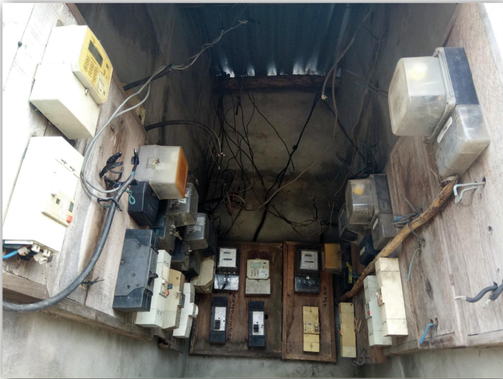
PHOTO 52 : CABANE À COMPTEURS VUE DE L'INTÉRIEUR
