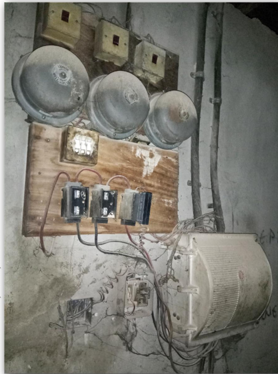
PHOTO 61 : AVERTISSEUR SONORE DU RETOUR DU COURANT DANS LE RÉSEAU
