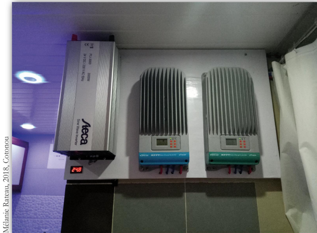
PHOTO 73 : CONVERTISSEUR ET RÉGULATEURS DE CHARGE SOLAIRE
