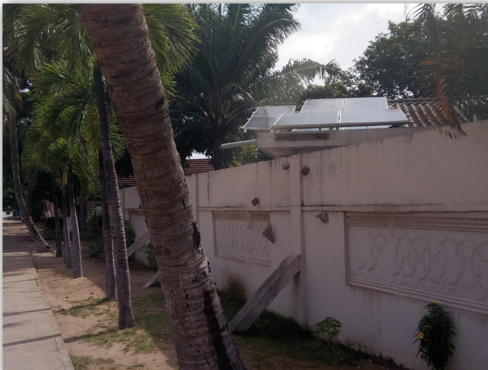
PHOTO 71 : DIX PANNEAUX SOLAIRES PHOTOVOLTAÏQUES DOMESTIQUES
