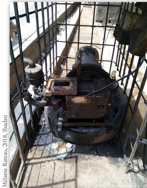
PHOTO 17 : GROUPE ÉLECTROGÈNE D'UN IMPRIMEUR DANS UN ABRI EN GRILLES ET TÔLES
