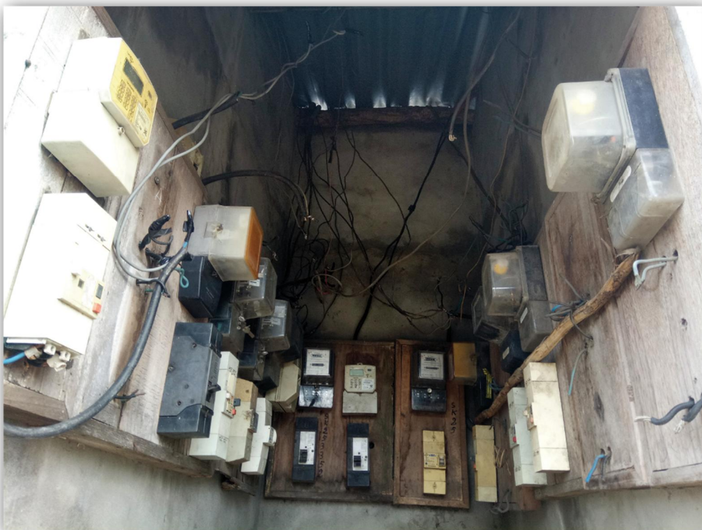
PHOTO 52 : CABANE À COMPTEURS VUE DE L'INTÉRIEUR
