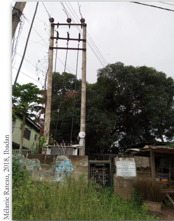
PHOTO 34 : UN TRANSFORMATEUR DE NEW-BODIJA ACCESSIBLE À TOUS
