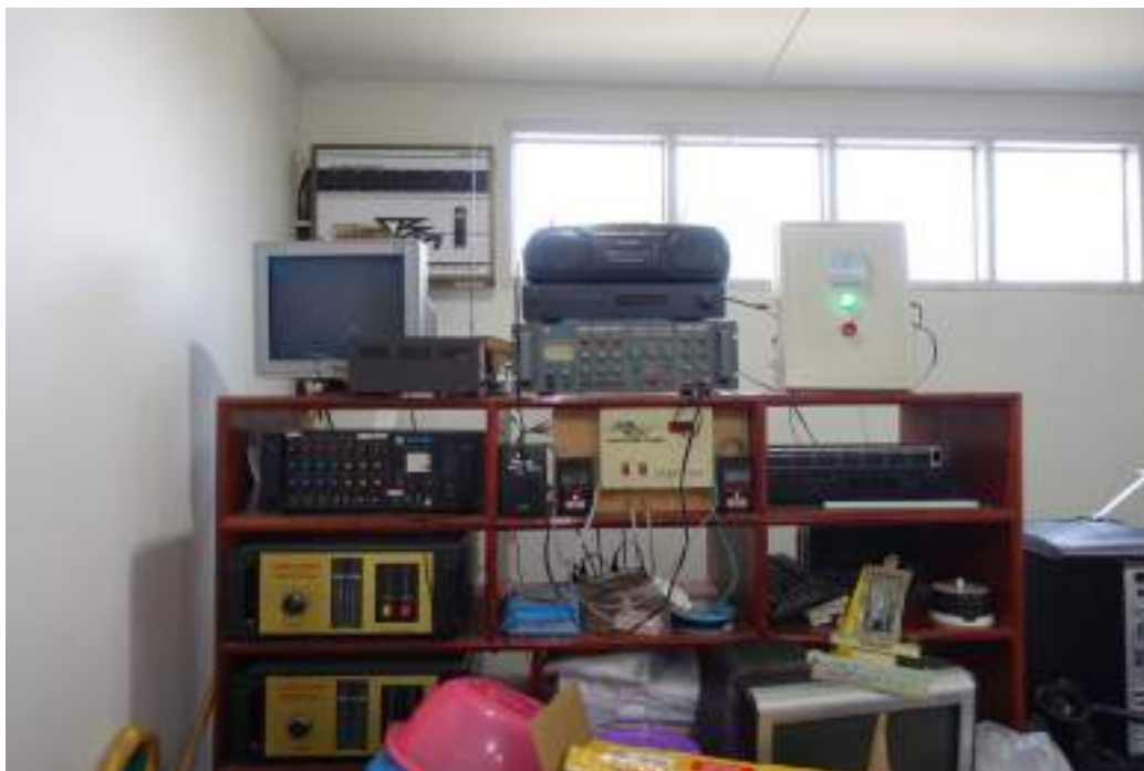
Figure 125 Installation technique principale et centrale du réseau du son filaire de la municipalité de Phetchabun, 12/12/2017.
