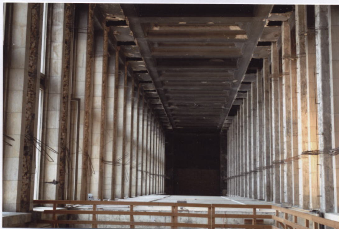
251 Partie supérieure du hall d'accueil, avec ses piliers en BA dans l'attente de leur habillage, et son plafond en stuc à caisson, dans son état de la fin de la guerre . 2005.
