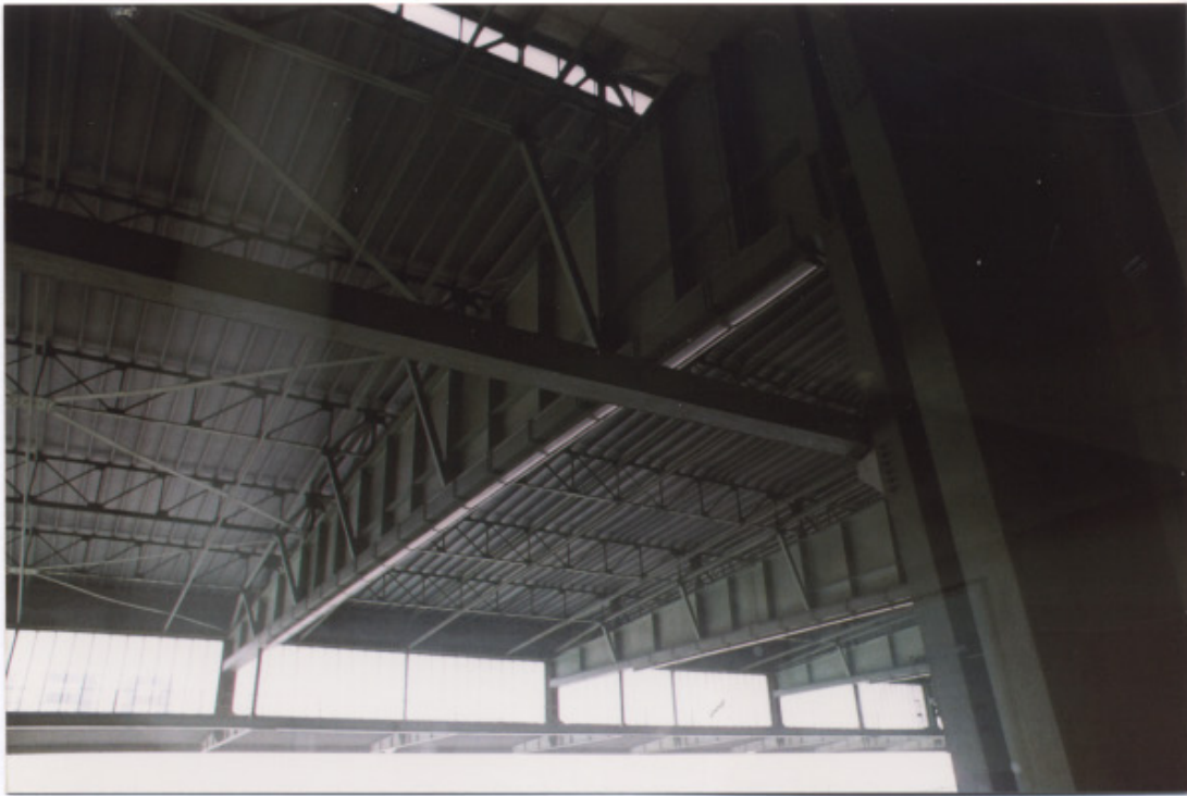
238 Le système complet de la charpente du hall d'embarquement qu'aucun habillage ne dissimule.
