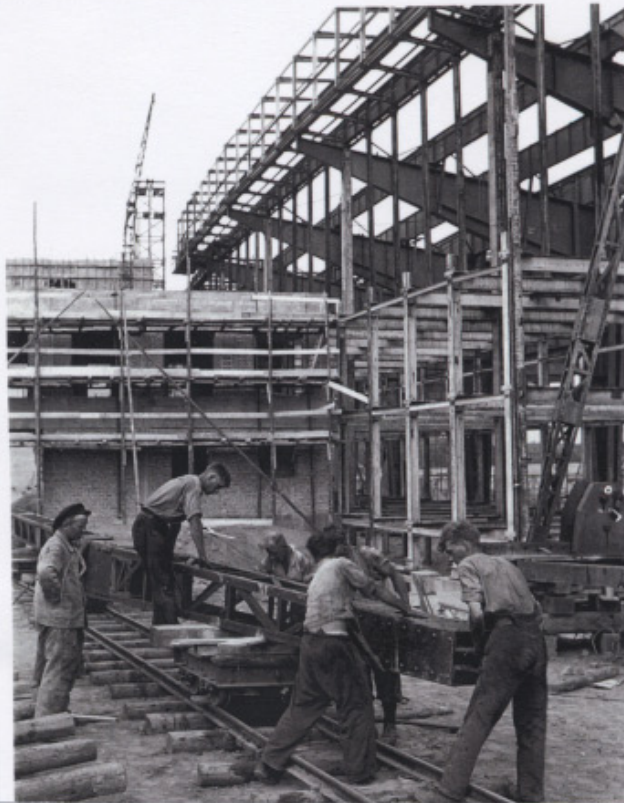
242 Photo de chantier du hall d'embarquement. L'arrière des poutres en cantilever est visible avec leur tirant venant s'ancrer dans le sol.
