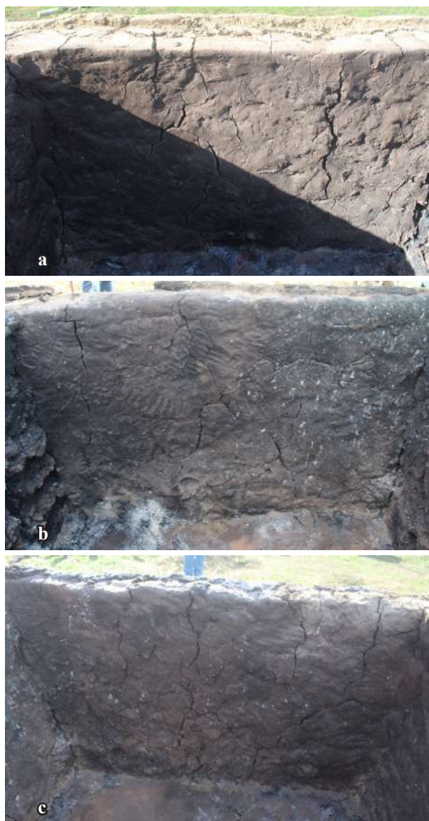
Fig. 5-148 - État des parements intérieurs des murs après l'incendie du bâtiment. Éch. hauteur du mur = 1 m. a. mur nord ; b. mur sud ; c. mur ouest.
