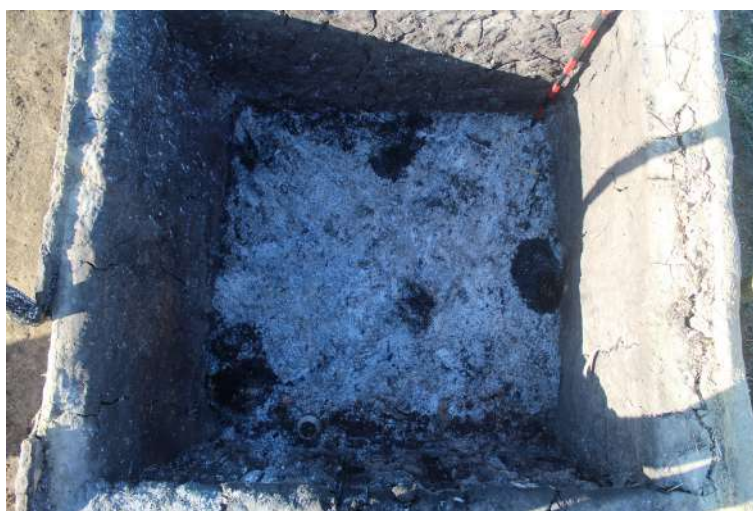
Fig. 5-151 - Intérieur du bâtiment après incendie.
