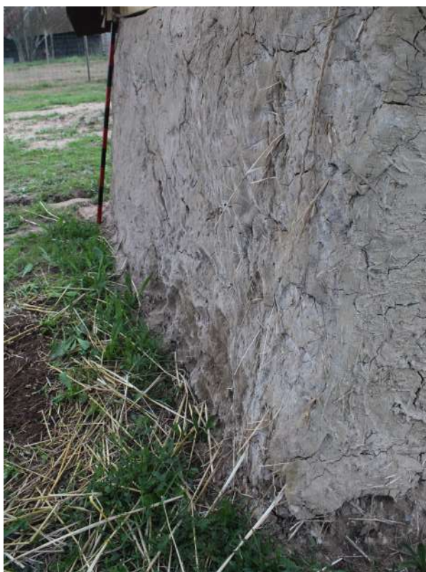
Fig. 5-119 - Phénomène d'affouillement lié au ruissellement de l'eau au pied des murs formant l'angle sud-est du bâtiment.
