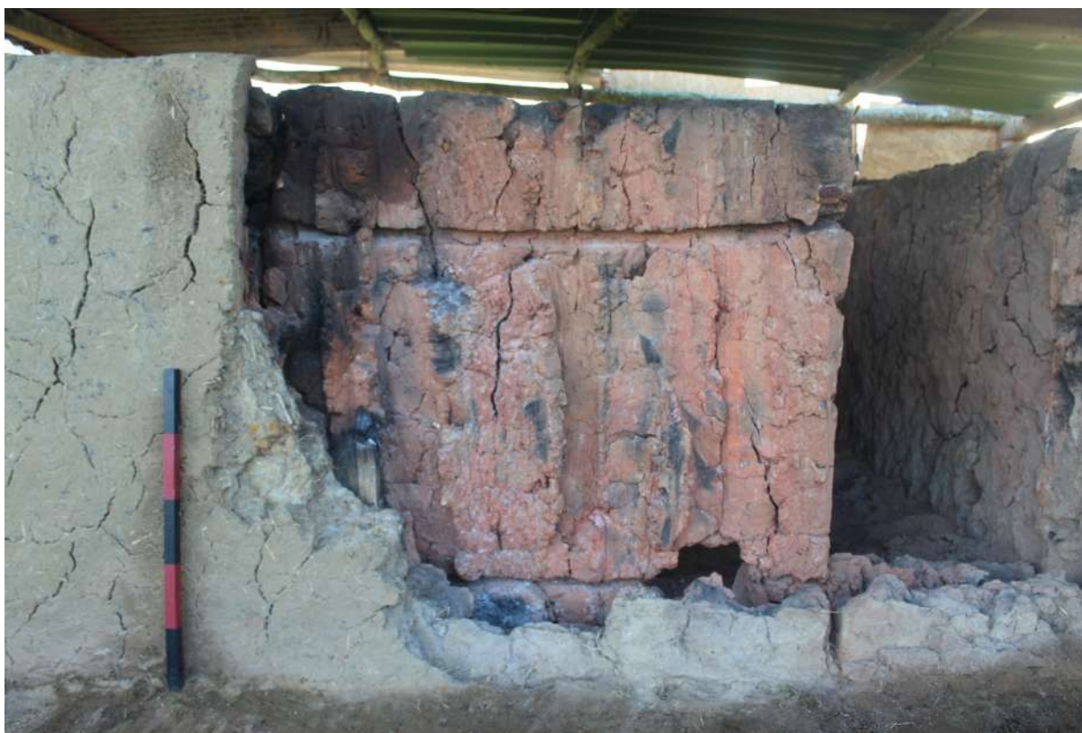
Fig. 5-164 - Démontage du mur nord, la terre à bâtir autour des empreintes a bien brûlé.
