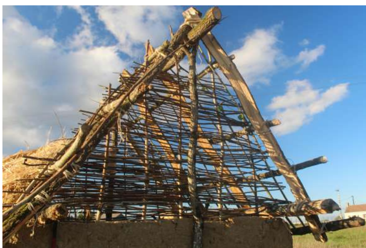
Fig. 5-132 - Vue vers le nord-est du clayonnage fermant le pignon du mur sud.
