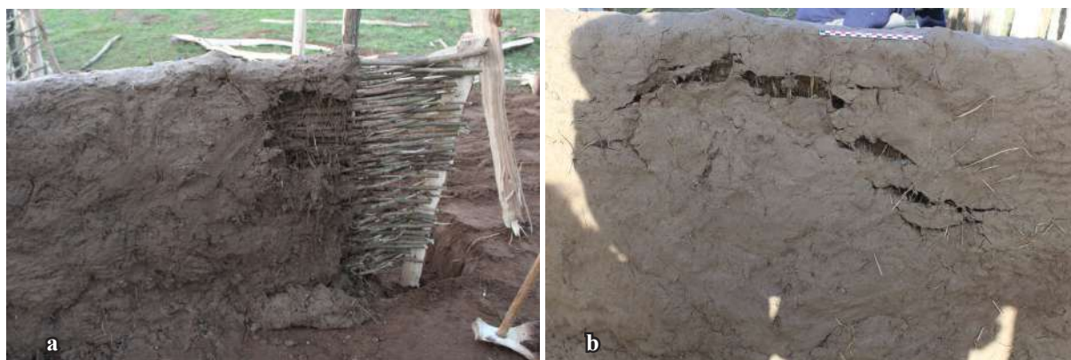
Fig. 5-101 - Mur sud, parement extérieur, construit avec la terre à bâtir issue des fosses. a. effondrement d'une partie de la couche de torchis ; b. affaissement de la couche.
