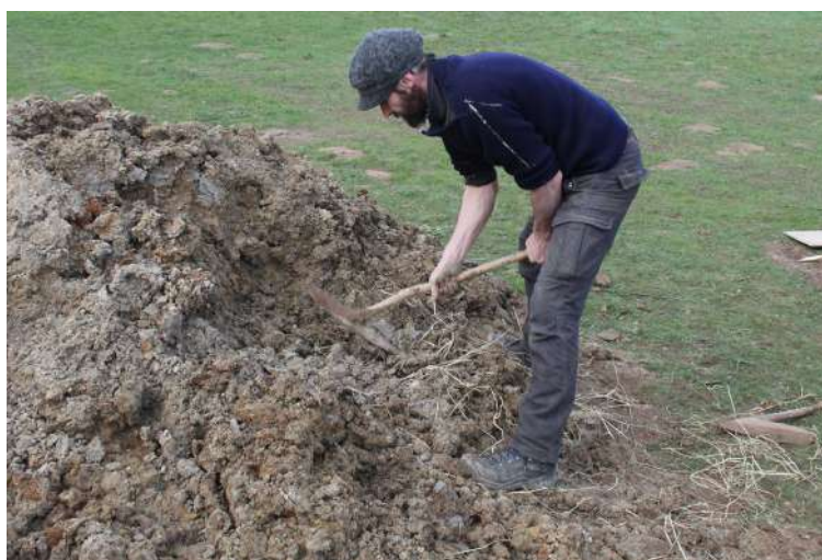
Fig. 5-94 - Fabrication de la terre à bâtir à même le tas de terre argileuse à l'aide d'un pic en bois.
