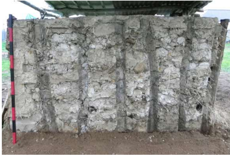
Fig. 5-166 - Parement extérieur du mur est après démontage des enduits et de l'armature en bois. Les empreintes des poteaux et des planches sont bien visibles.
