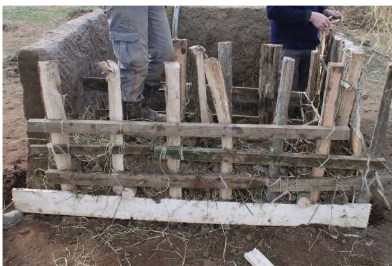
Fig. 5-103 - Tassement du blocage entre les deux parements en marchant sur les couches de terre.
