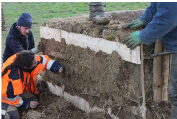
Fig. 5-108 - Application d'un premier enduit contre le parement extérieur en bois du mur est.
