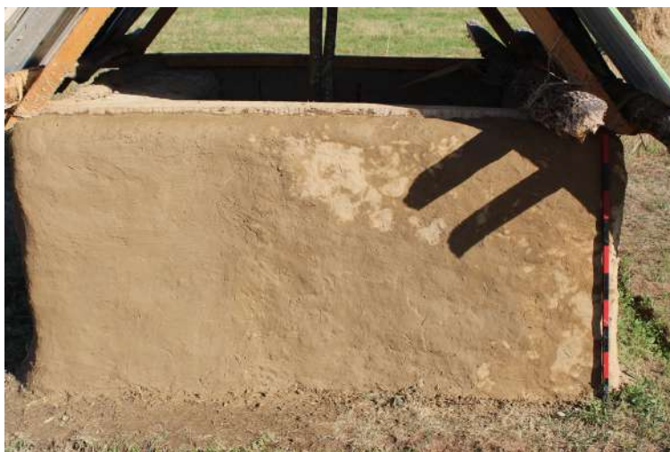
Fig. 5-117 - Parement extérieur du mur nord, enduit très fin appliqué sur tout le parement pour combler les fissures.
