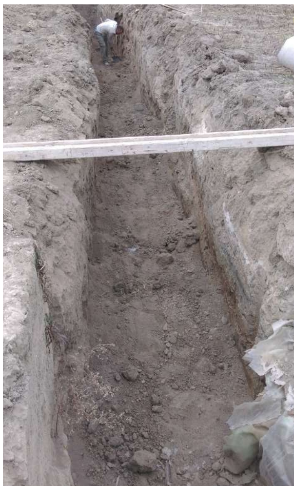
Fig. 4-02 - Vue vers le nord de la tranchée D creusée pour retirer le tuyau d'irrigation installé dans les années 1970. Cliché par A. Chohadzhiev.
