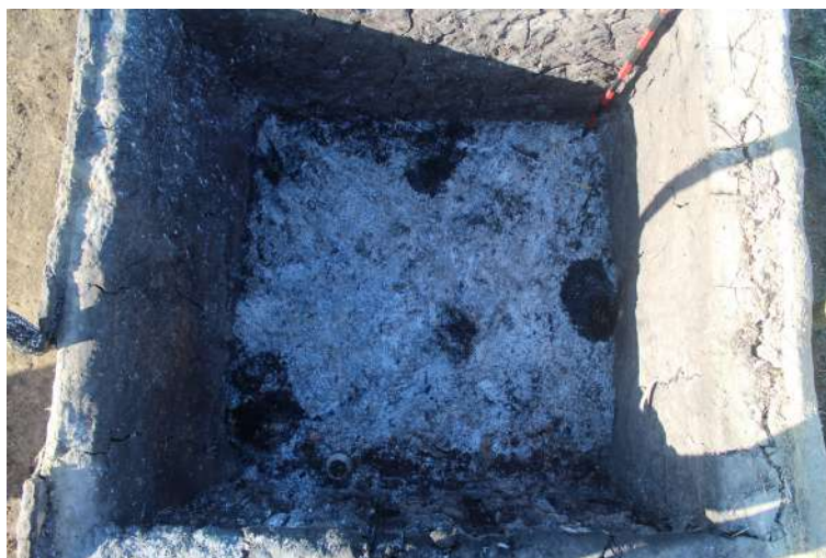
Fig. 5-151 - Intérieur du bâtiment après incendie.
