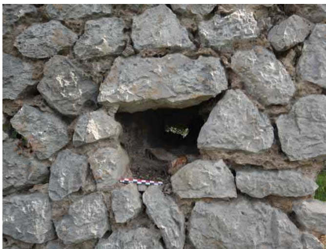
FIG. E.20 – La muraille de Terracine : trou de boulin traversant
