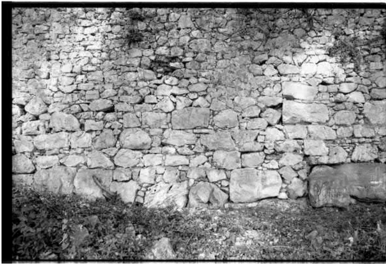
FIG. E.3 – La villa Prato : mur ouest du podium (photographie H. Broise et X. Lafon, neg. 2231)
