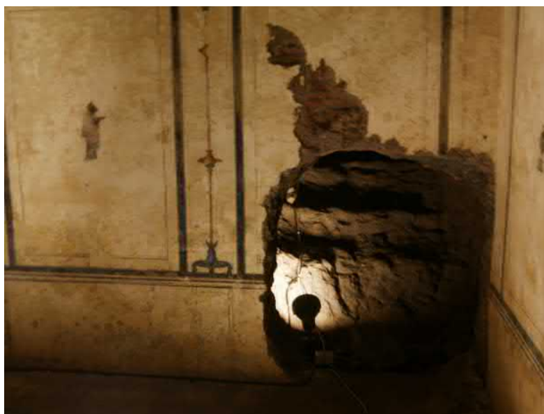
FIG. E.44 – La pyramide de Cestius : maçonnerie interne visible dans un trou de tombaroli (photographie C. Dubois)
