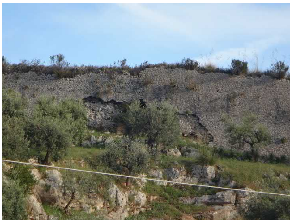
FIG. E.24 – La muraille de Terracine : arrachement du muret externe entre T7 et T8
