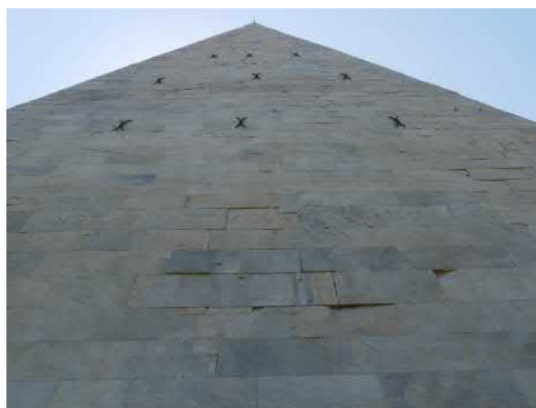
FIG. E.42 – La pyramide de Cestius : revêtement de marbre et inscriptions (photographie C. Dubois)
