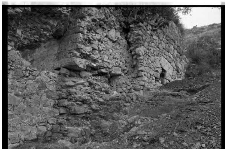
FIG. E.4 – La villa Prato : effondrement du muret de parement à l'angle sud-ouest du podium (photographie H. Broise et X. Lafon, neg. 2187)
