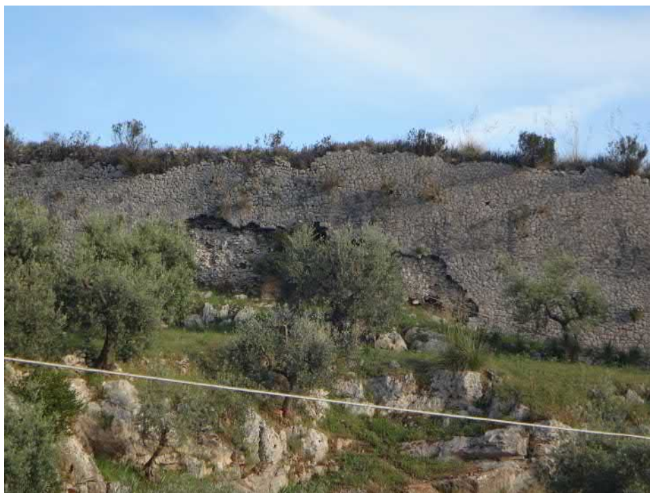
FIG. E.24 – La muraille de Terracine : arrachement du muret externe entre T7 et T8
