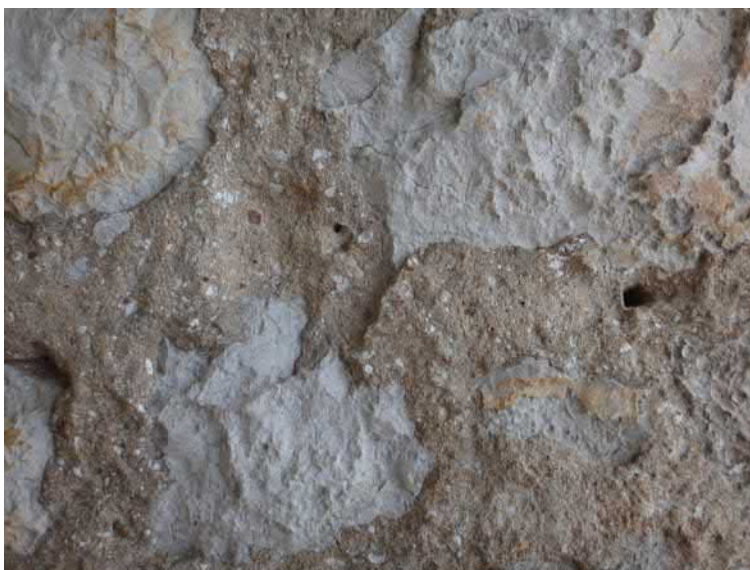
FIG. E.14 – La muraille de Terracine : mortier
