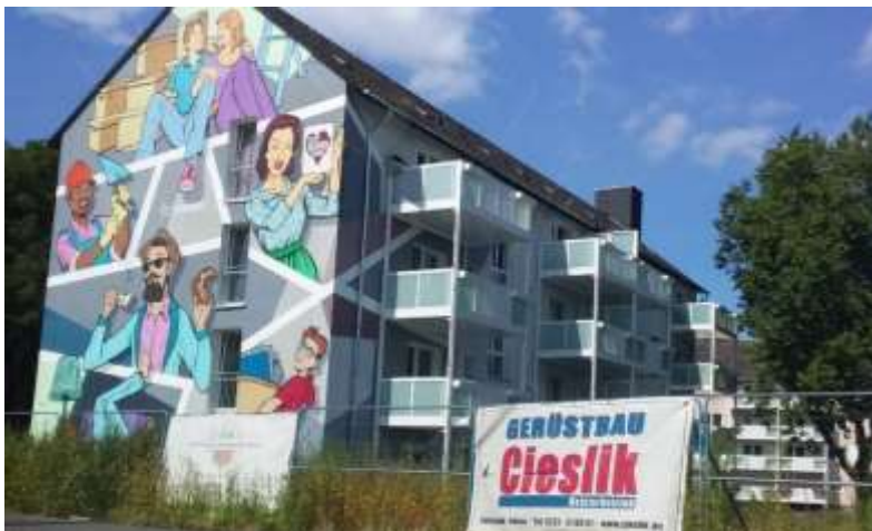
69 Dortmund, 24/08/2021, MIR. Travaux de rénovation avec pose de balcons, changements de vitre...
