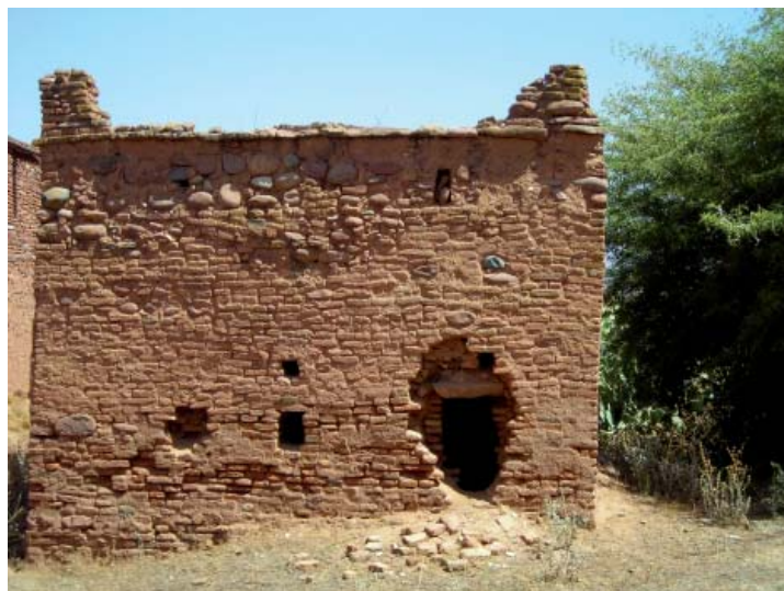
Photo. 2 : Vue de la paroi Ouest du mausolée de Sīdī Sa‘dūn (2/A/M) percée d’une baie. (© Bulle Tuil )
