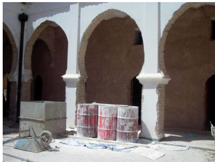
Photo. 4 : Portique de la madrasa desservant les cellules du premier niveau. (© Bulle Tuil )
