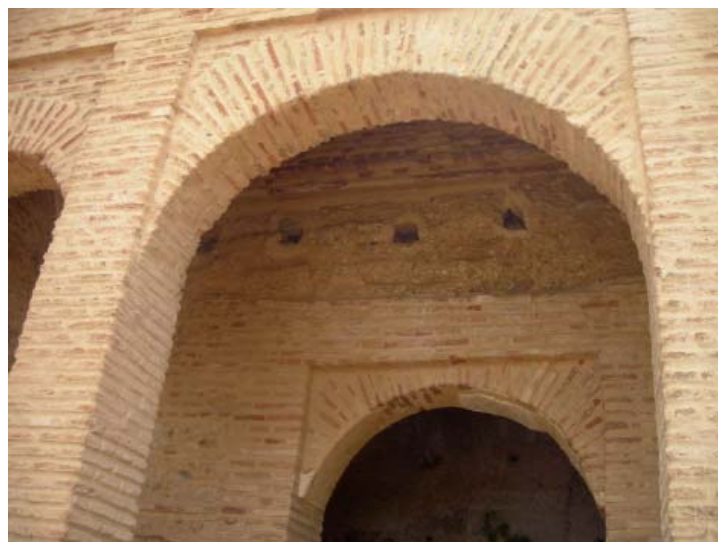
Photo. 2 : Portique du bâtiment 3 desservant la grande pièce Sud ainsi que les deux petites pièces Ouest et Est. (© Bulle Tuil )
