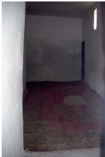
Photo. 3 : Salle de retraite spirituelle localisée à l'arrière de l'oratoire du mausolée de Sīdī al-Ṣāliḥ (1/S/M). (© Bulle Tuil )
