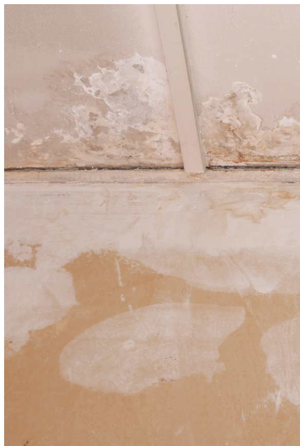
Infiltrations d'eau dues à l'absence d'étanchéité des loggias © Mathilde Padilla, 2019
