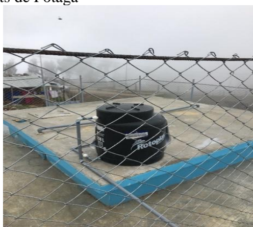
Photo 5 : Réservoir et cuve où a lieu la chloration
