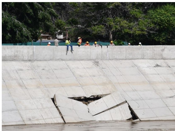
Photo 12 : Les dalles des ouvrages de défense de la Piura construits en 2022 tombent quelques mois après leur mise en place
