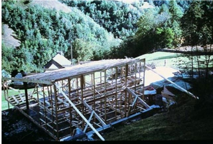
Figure 46. Chantier-montage de l'ossature préfabriquée du chalet à Barèges (1966) : Le projet d'un chalet pour son propre usage orienta Pierre Lajus vers la préfabrication en bois. © Pierre Lajus 103
