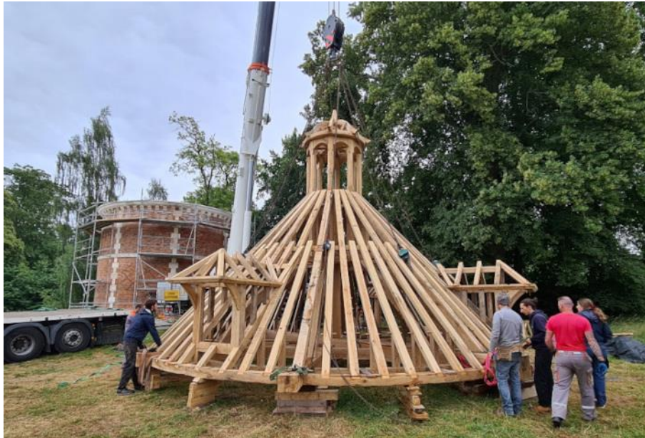
Figure 72. Colombier du château de Honguemarre : La reconstruction de la charpente d'un colombier du XVIIe siècle en Normandie fut réalisée à partir de rares morceaux pourris et de quelques photographies qui présentent l'ancienne construction. © Francis Plagnol 106
