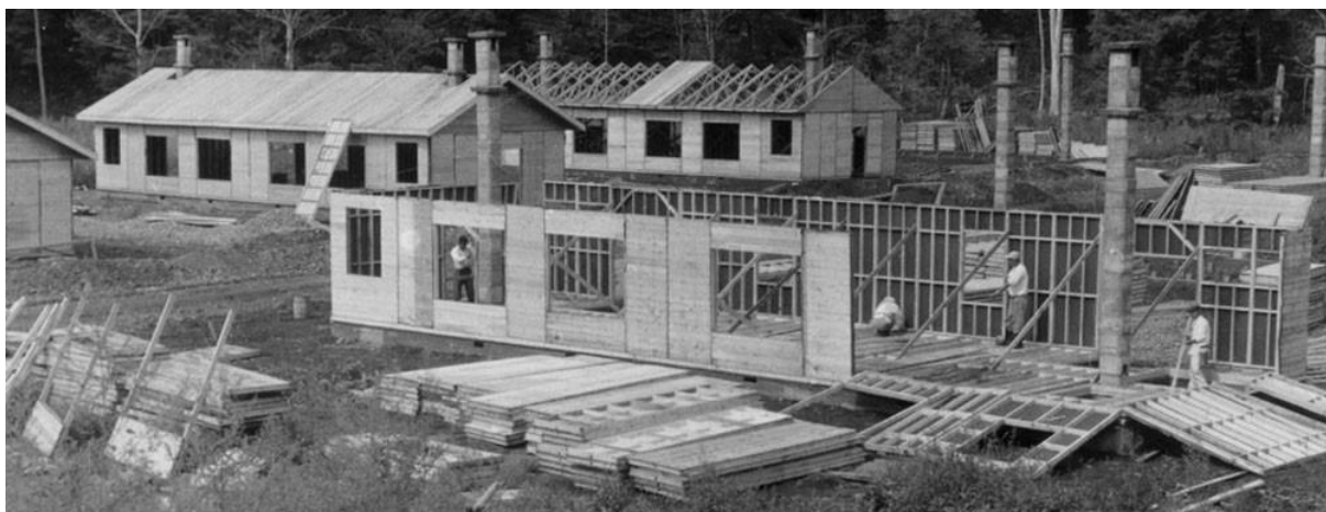
Figure 40. Un chantier de construction de Premos (1946) : Le Premos, conçu par Maekawa Kunio, est connu comme une tentative précoce au Japon de produire des logements par préfabrication (photo présentée dans Shinkenchiku ). 59
