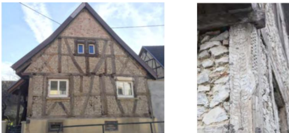
Figure 34. Réhabilitation d'une maison à Zimmersheim : la structure de cette maison, composée de pièces de bois sculptées, avait été sérieusement endommagée en raison de la présence de crépi. © Push architecture 161
