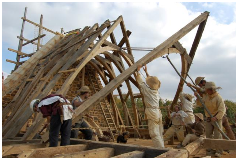
Figure 13. La mise en œuvre de la charpente à chevrons-formant-fermes au château de Guédelon : La charpente à chevrons-formant-fermes se compose de fermes similaires et indépendantes, utilisant des pièces de bois de faible diamètre qui conservent le cœur d'arbre. © Frédéric Épaud 151
