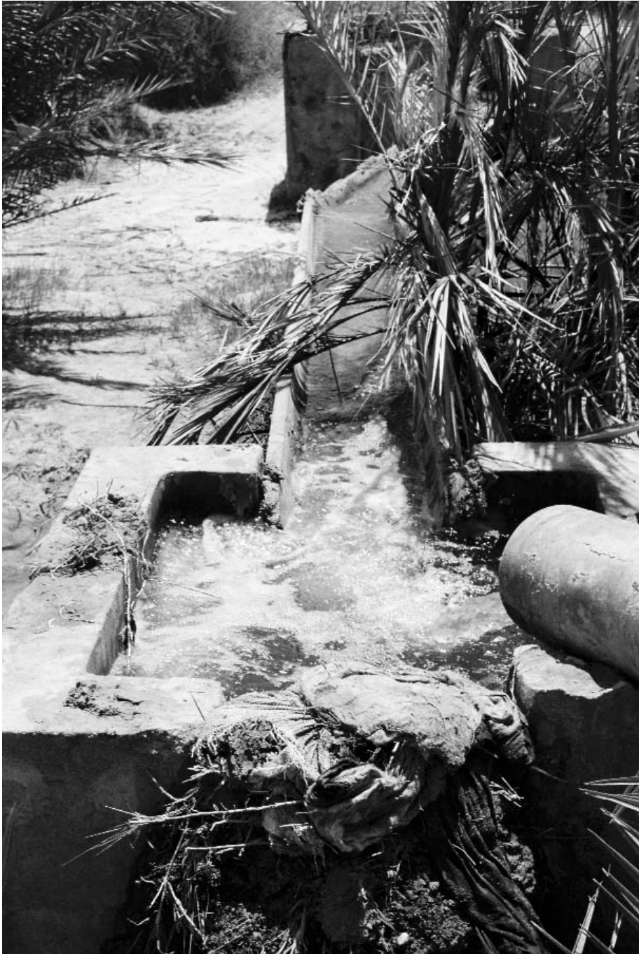
Réseau d'eau étatique bricolé. Juillet 1995, Nefta (Tunisie). Une partie du réseau d'eau installé par l'État à Nefta est enterrée, une autre aérienne. Les jardiniers se les réapproprient partiellement en les « bricolant ».
