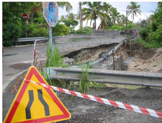
Photo 3. Exemple des dégâts occasionnés à La Réunion (Grand Fond) lors de la tempête tropicale précédente du 18 au 23 février 2006
