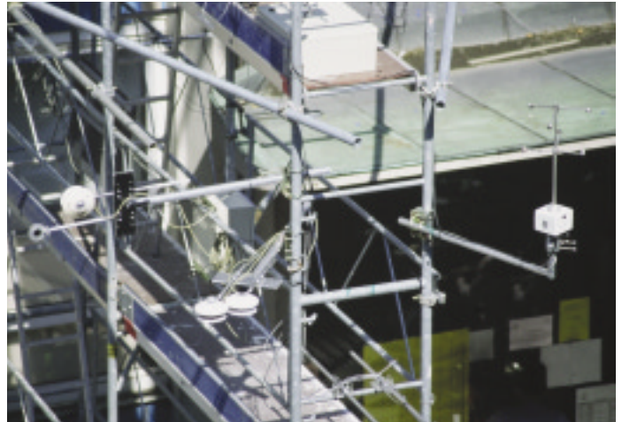
▲ Figure 2 : Appareils de mesures installés sur l'échafaudage de la rue de l'Argonne.
