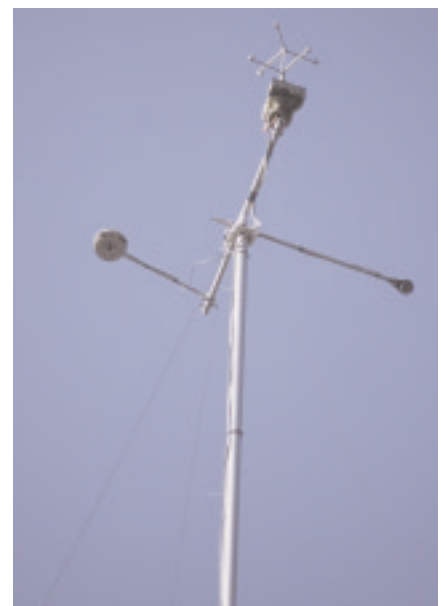
Figure 3 : Instruments de mesure installés au sommet d'un mât de 30 m.
