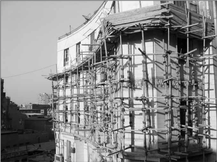
12. Ravalement de façade d'un immeuble de la place Orabi, Centre-Ville, Le Caire, 27 juillet 2004 (18h32).
