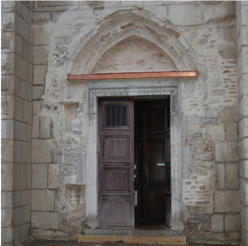
Fig. 3 - Saint-Claude, ancienne abbatale (cathédrale), portail gothique après le démontage partiel du portail moderne (cl. R. Le Pennec, APAHJ, 2005).
