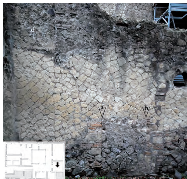
Fig. 171 – Casa del telaio (V, 3), pièce I, mur sud. Après le second séisme, les dégâts ont été réparés en employant de l' opus vittatum mixtum à deux assises de briques, pour les montants est (a) et ouest (b) de la porte donnant au sud, au rez-de-chaussée comme à l'étage (c). Peu après, quand la pièce 5 est cédée à la Casa del gran portale (V, 35), ces deux portes sont bouchées (d-e). Le bouchage (f) correspond au déplacement de l'escalier.
