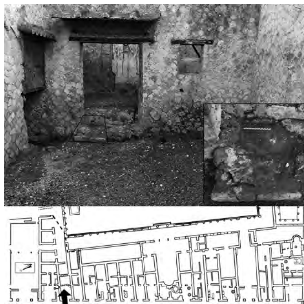
Fig. 141 – Boutique Or. II, 16, local principal. Le mur de refend qui sépare cette boutique de la pièce annexe s'appuie sur un mur antérieur partiellement arasé, comme en témoigne l'enduit laissé sur ce dernier, englobé dans la marche (encadré).
