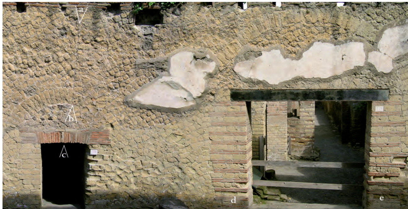
Fig. 191 – Façade orientale des thermes, entrées VI, 9 et VI, 10 (montage numérique de photos). La porte VI, 9 s’est écroulée dans sa portion nord, selon une ligne de fracture claire (a-b), l’arc a été remplacé par un linteau clavé (c). En revanche, sans que cela ne soit lié à un effondrement, les montants de la porte VI, 10 ont été remplacés après le second séisme (d, e).
