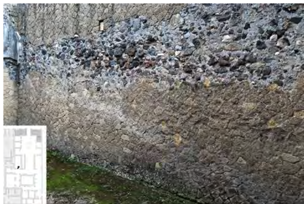
Fig. 189 – Casa del salone nero , pièce N, mur est. Les parties inférieure et supérieure du mur ont été détruites par un tunnel. Seul subsiste une ligne d' opus incertum D, caractéristique des réparations consécutives au séisme.
