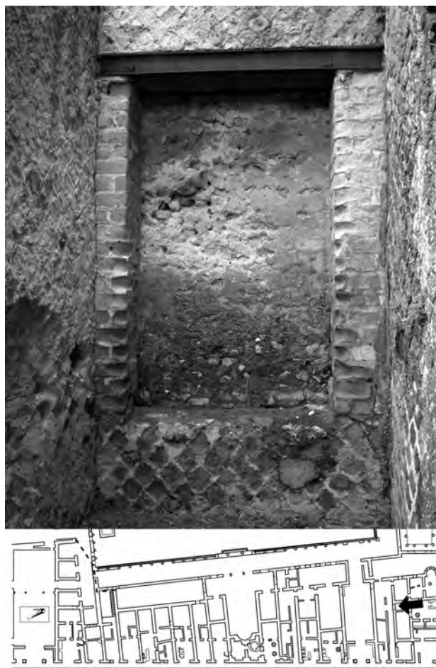
Fig. 129 – Porte bouchée dans la paroi nord de la pièce 1a-4 de l'Insula Orientalis II a . Ouverte lors du projet initial, cette porte permettait le passage entre les pièces 1a-11 et 1a-4 grâce à une volée de trois marches.
