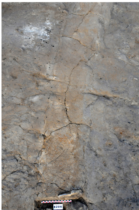
■ Fig. 12 : Vue de détail de la mise en oeuvre de la base de mur en bauge MR53638, dans la partie méridionale de l'UNF139.
