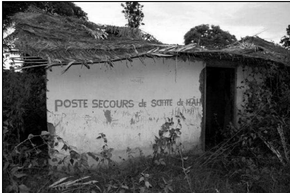
Photo 1. Poste de santé abandonné suite à la fuite du personnel de santé (District de Kimba)
