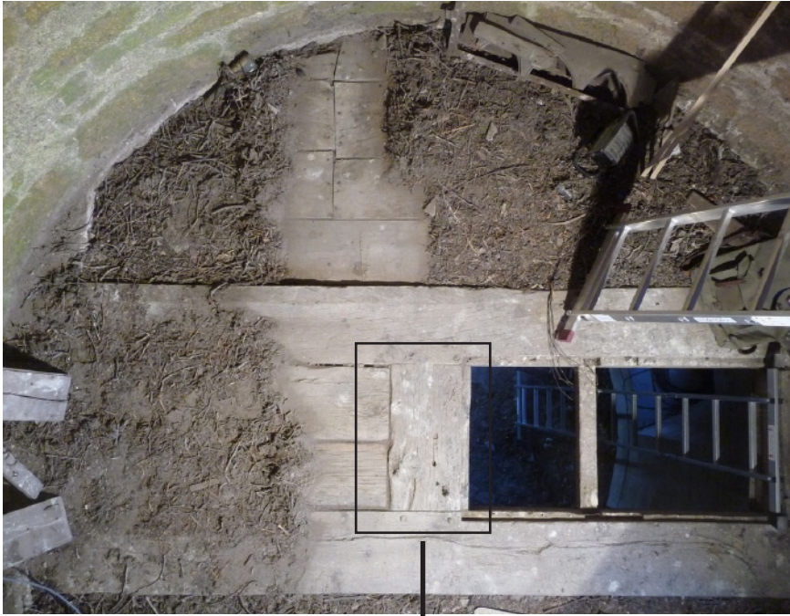
Fig. 26 : troisième niveau, structure du plancher entre le deuxième et le troisième niveau, vue plongeante. (Cl. R.P.L.)
