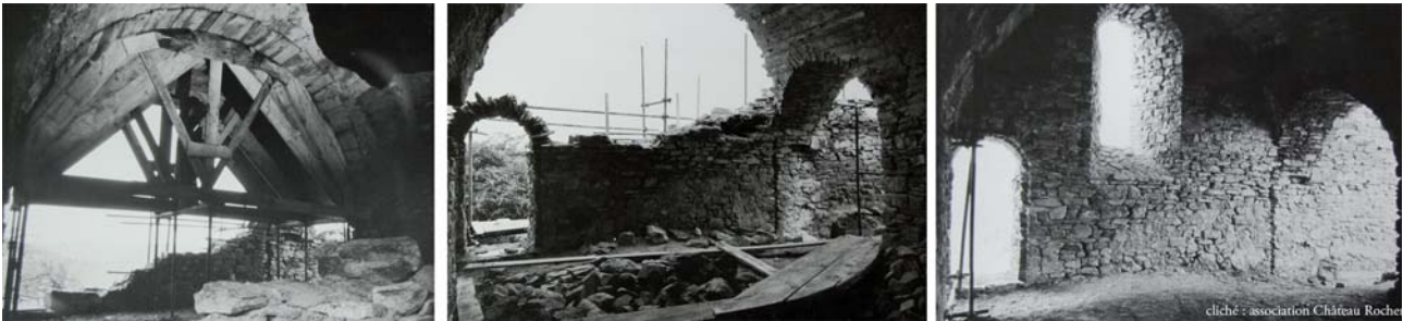
Fig. 7 : Vue de la pièce 14 en cours de restauration depuis le sud (association Château Roche).
