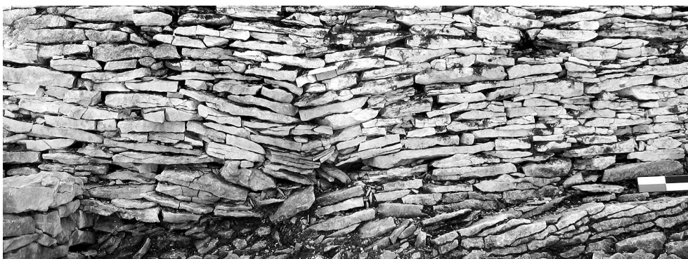
Fig. 16. Désordres de la maçonnerie sur le parement interne du mur gouttereau ouest de la grange de la ferme 2 (cliché P. Beck).
