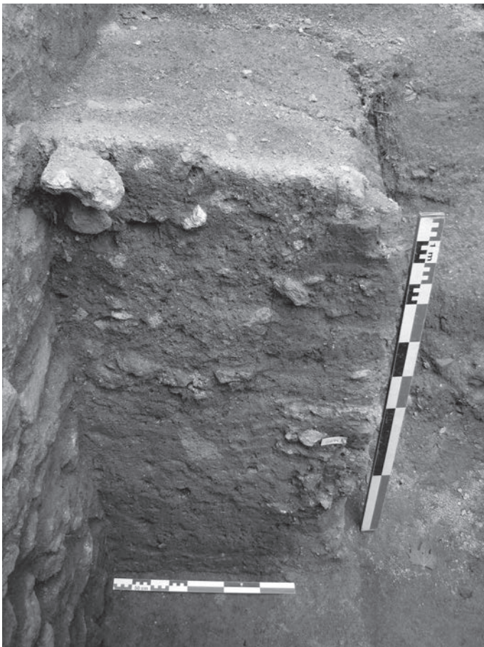
Fig. 41 – Indices de reprise en sous-œuvre du mur M9 durant l'état 4a ? (cliché : Y. Labaune, SAVA).
